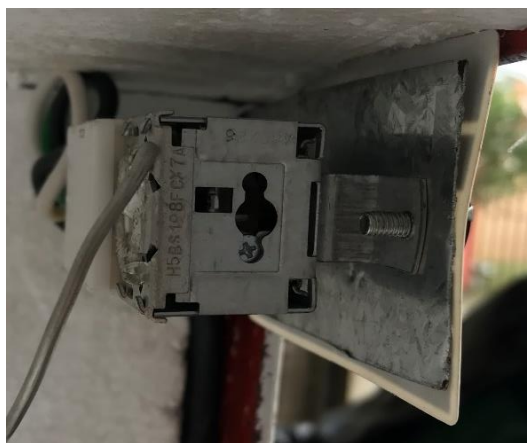
Figura 49. Termostato instalado en refrigeradora, parte trasera.
