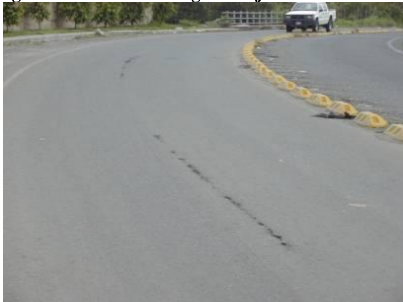
Figura 23. Grieta a lo largo de la junta de los carriles.
