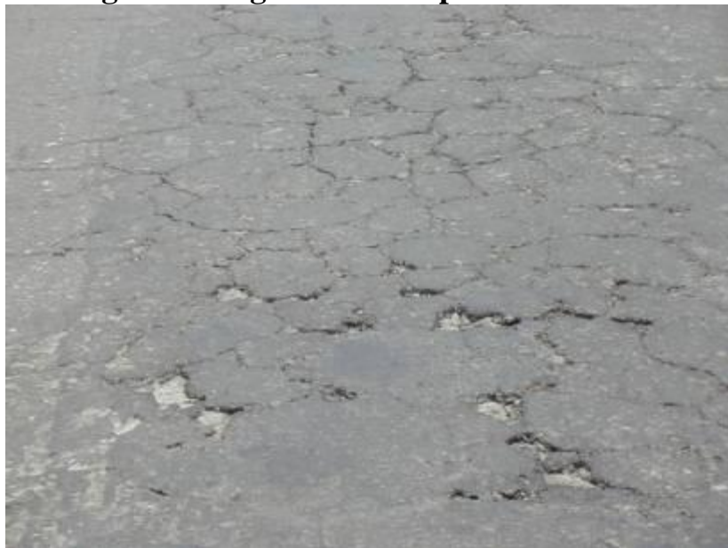
Figura 21. Agrietamiento piel de cocodrilo
