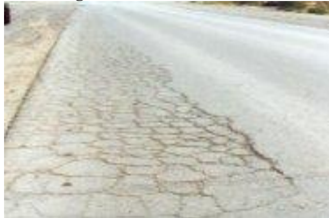
Figura 22. Grieta en borde.
