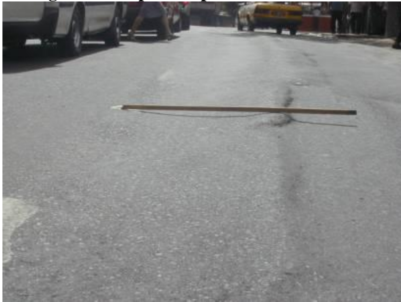
Figura 26. Depresión por efecto del tránsito.
