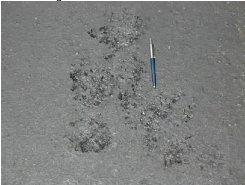
Figura 28. Exudación del asfalto.
