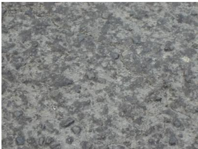
Figura 29. Agregado pulido en pavimento.
