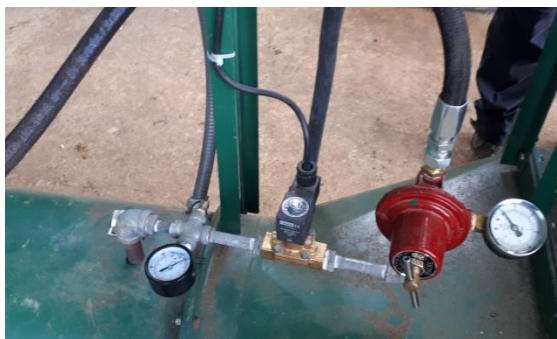
Ilustración 25 Línea de control de gas de secadora de 70 quintales
