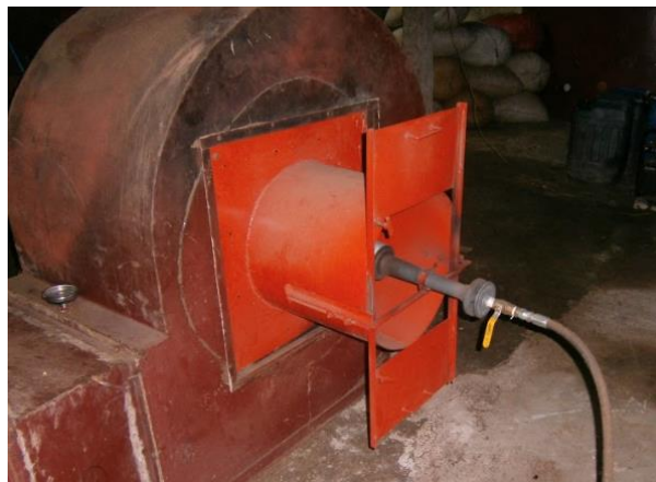
Ilustración 23 Quemador atmosférico en la entrada de un ventilador centrífugo
