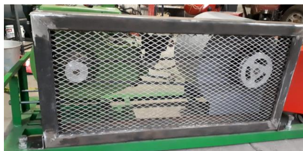
Ilustración 100 Guarda instalada en sistema de potencia
