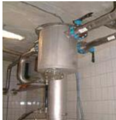
Ilustración # 22: Filtro de biogás
