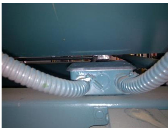
Figura 11: Caja de registro rectangular parte inferior
