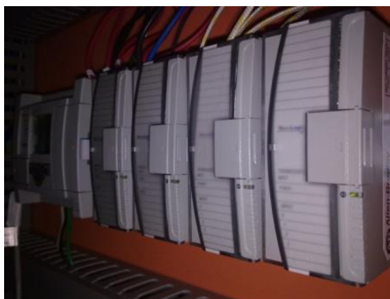
Figura 101: 2 módulos 1762-IF4 (entradas analógicas) y 2 módulos 1762-IT4 (entradas de termocoplas)
