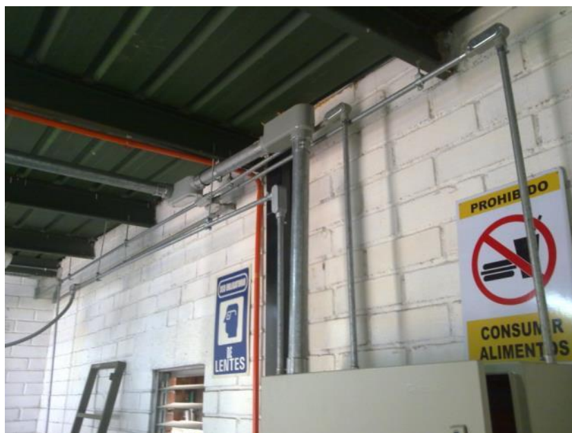
Figura 8: Tubería instalada que proviene de panel
