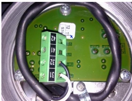
Figura 27: Instalación sensor de flujo de vapor (tipo Vortex)
