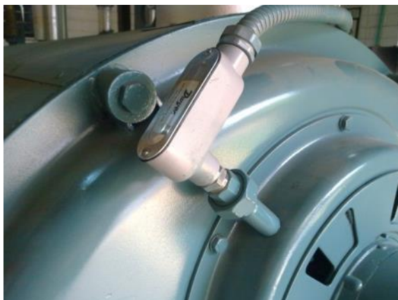
Figura 16: Sensor de velocidad de aire instalado
