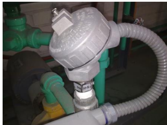
Figura 41: Termocopla tipo K roscada instalada
