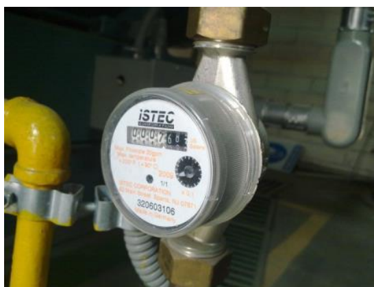
Figura 20: Sensor de flujo de agua instalado
