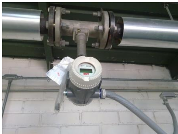
Figura 29: Sensor de flujo de vapor instalado
