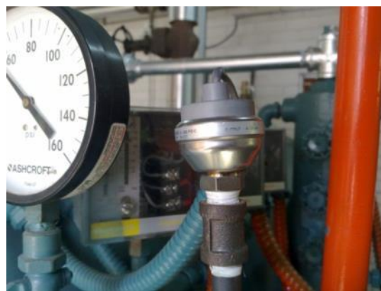
Figura 39: Sensor de presión interna de la caldera instalado
