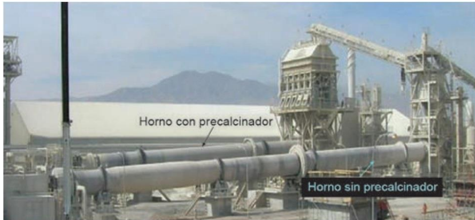
Figura 9. Horno horizontal de proceso continuo con y sin precalcinador.
