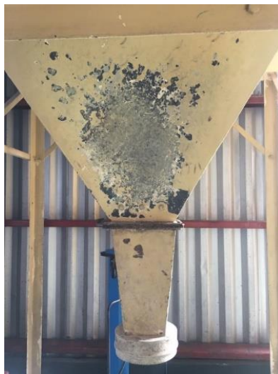
Figura 15. Tolva dañada del colector de polvos.
