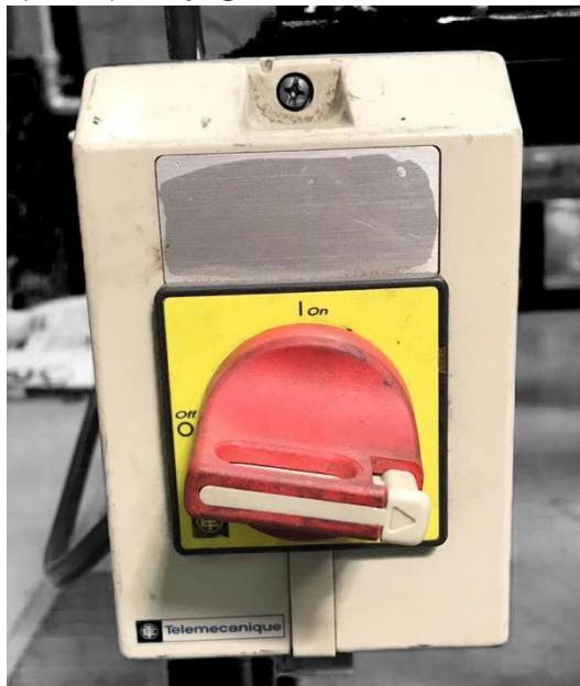
Figura No.1. Interruptor (switch) en posición de apagado.
