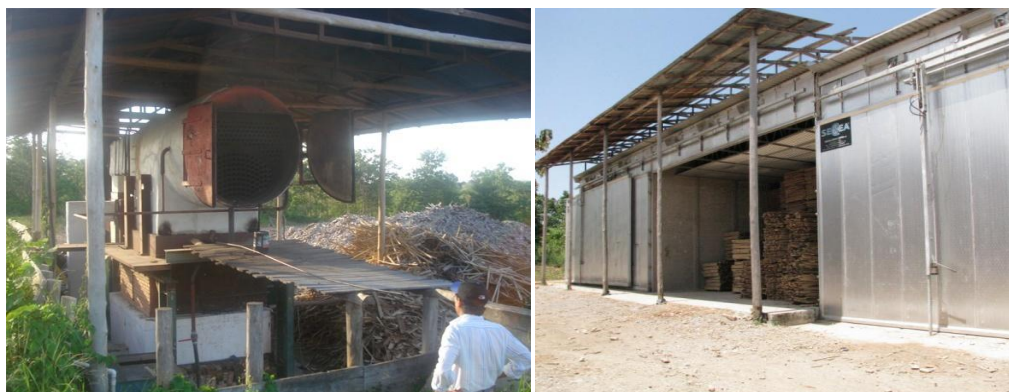
Figura 12. Caldera y hornos de secado
