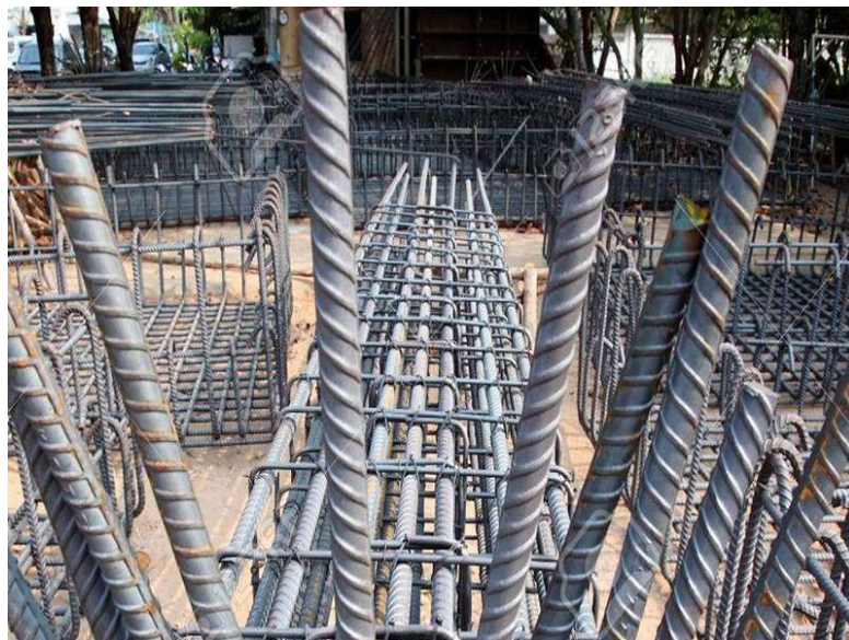
Ilustración 9. Varilla de acero de refuerzo.
