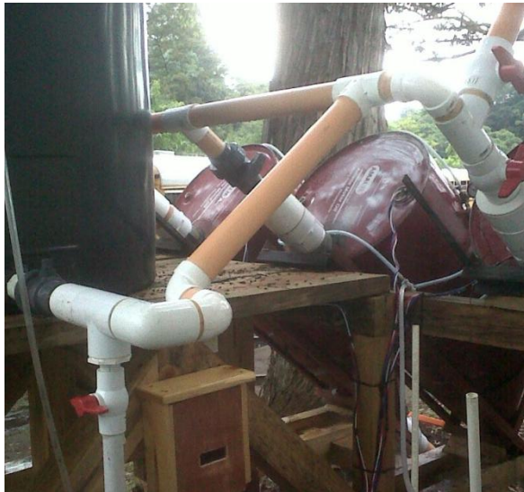
Ilustración 75: Tubería PVC ensamblada con Cámara de Carga
