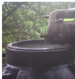
Ilustración 95: Bomba de drenado de fosa séptica
