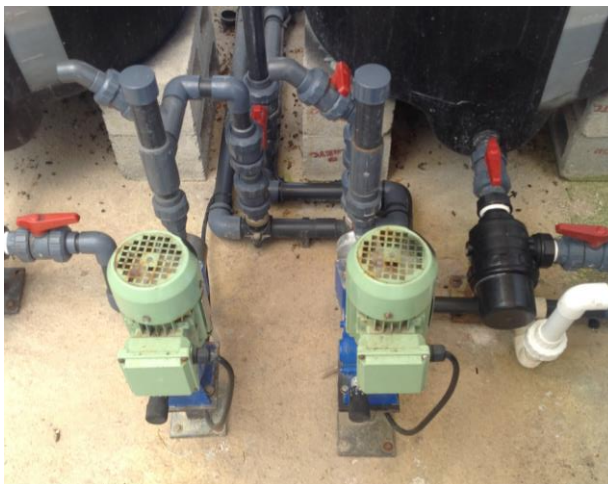
Figura 18. Dosificadoras de bombas de pistón para la solución nutritiva A y B
