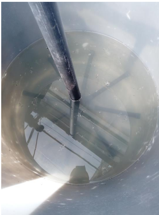
Figura 25. Sistema de tubería PVC para inyección de aire de la turbina
