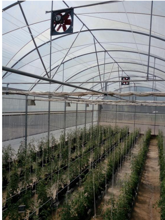
Figura 34. Ventiladores instalados a aproximadamente 7.5 metros de altura dentro del invernadero
