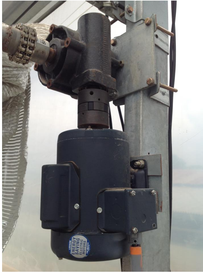
Figura 15. Motor marca Leeson de \frac{1}{2} HP para accionar la cortina UV y acople a la caja reductora
