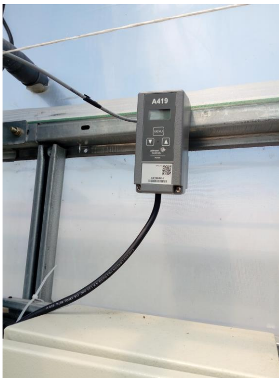
Figura 29. Termostato digital instalado dentro del invernadero
