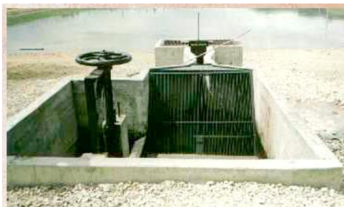
Imagen1: Rejillas para un pre tratamiento de agua residual
