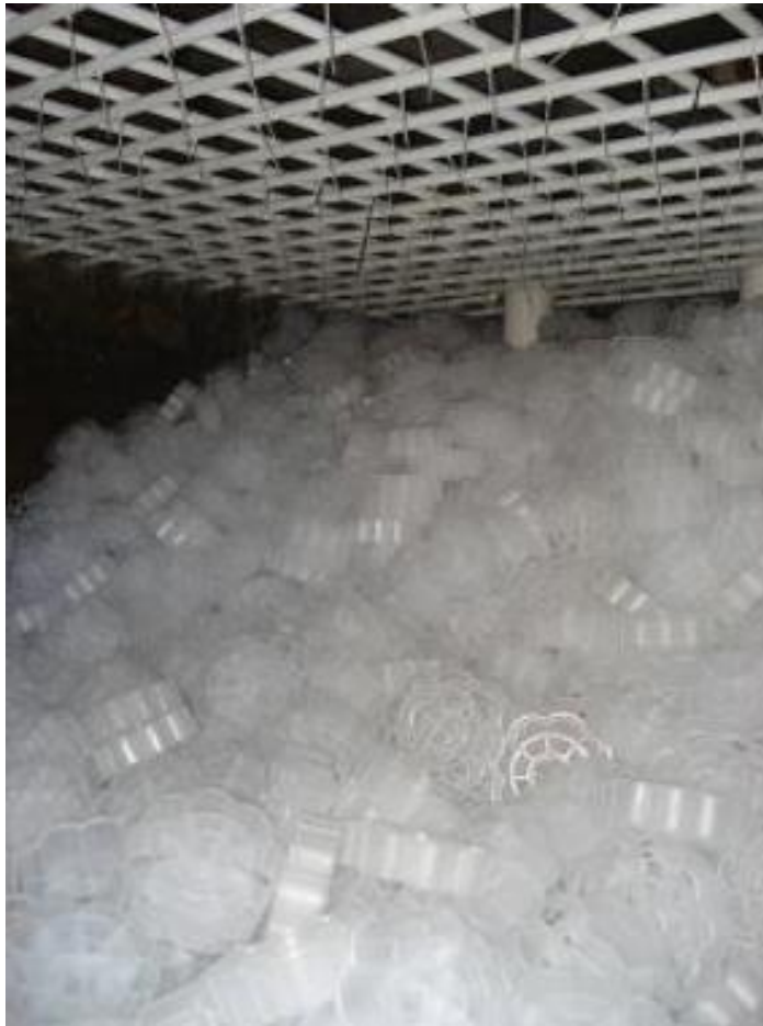
Figura 28: Detalle de malla biorreactor anaeróbico.
