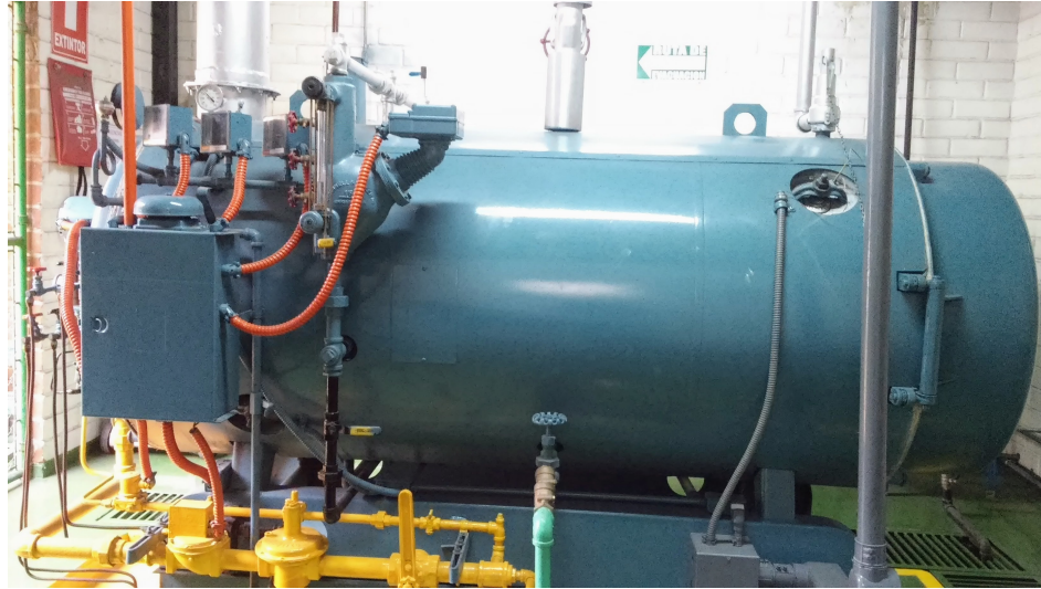
Figura XV.2: Fotografía de la caldera pirotubular
