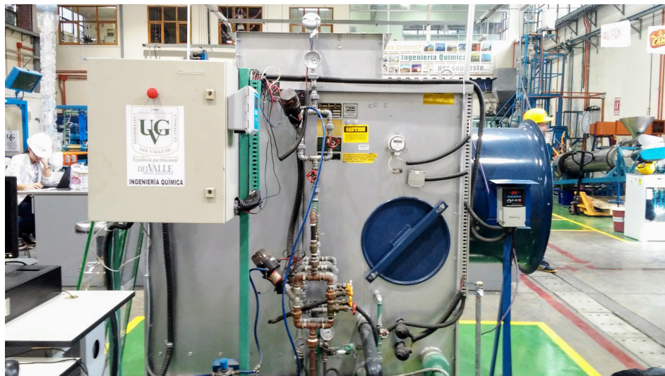
Figura XV.3: Fotografía de la torre de enfriamiento
