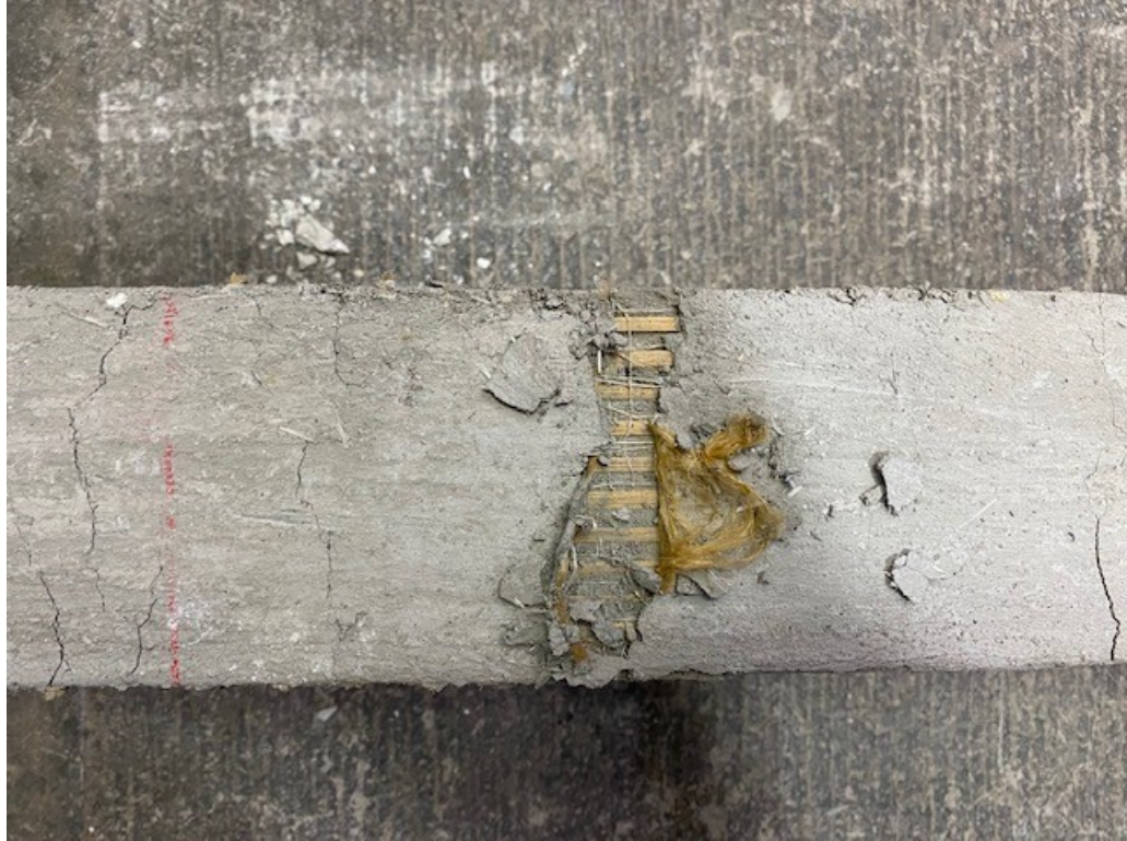
Figura 71: Anexo 19 – “Delaminación del material FRCC” (Fuente: Elaboración propia)
