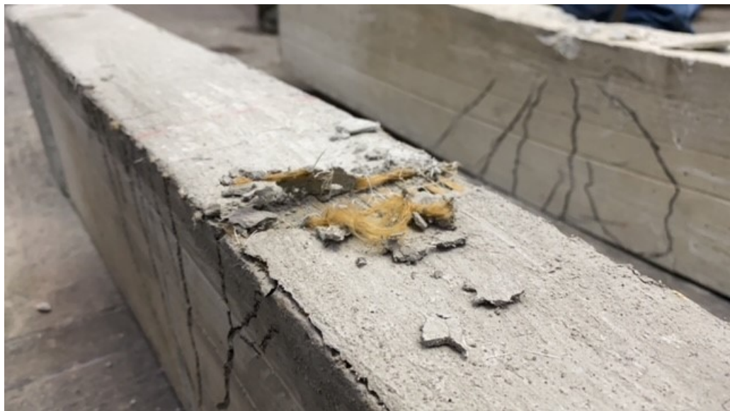
Figura 72: Anexo 20 – “Delaminación del material FRCC” (Fuente: Elaboración propia)
