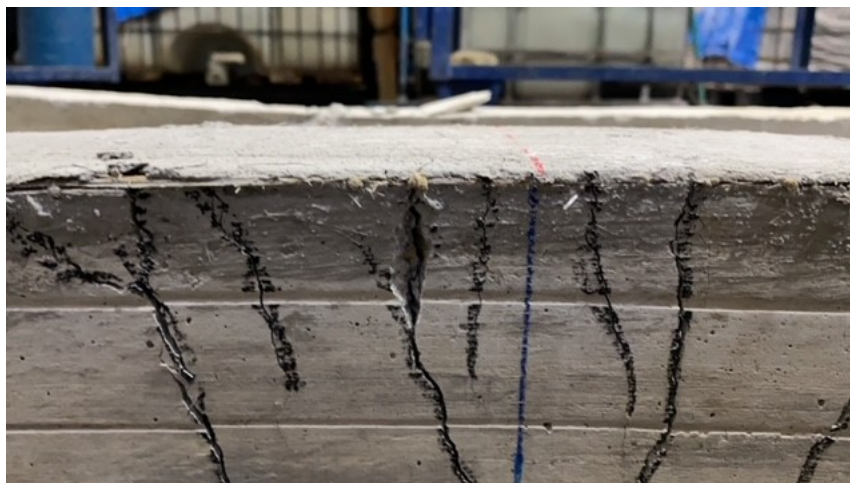
Figura 70: Anexo 18 – “Delaminación del material FRCM” (Fuente: Elaboración propia)
