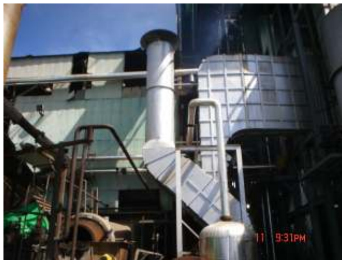
Ilustración 3.11: Entrada de aire y ducto del ventilador de tiro forzado
