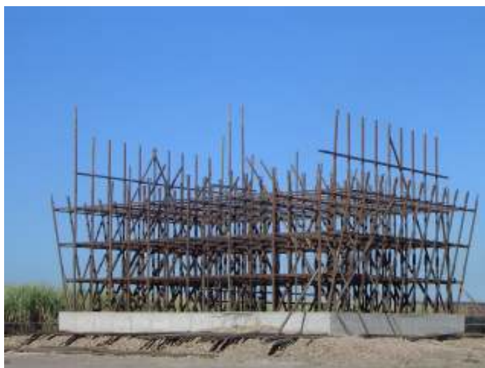
Ilustración 5.8: Elaboración de la torre de enfriamiento
