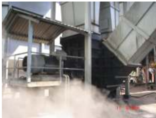
Ilustración 3.12: Motor y ductos del forzado
