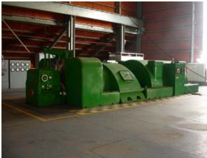
Ilustración 3.19: Turbogenerador General Electric instalado en la planta de generación térmica del Ingenio La Grecia con capacidad para producir 22 MW de potencia eléctrica
