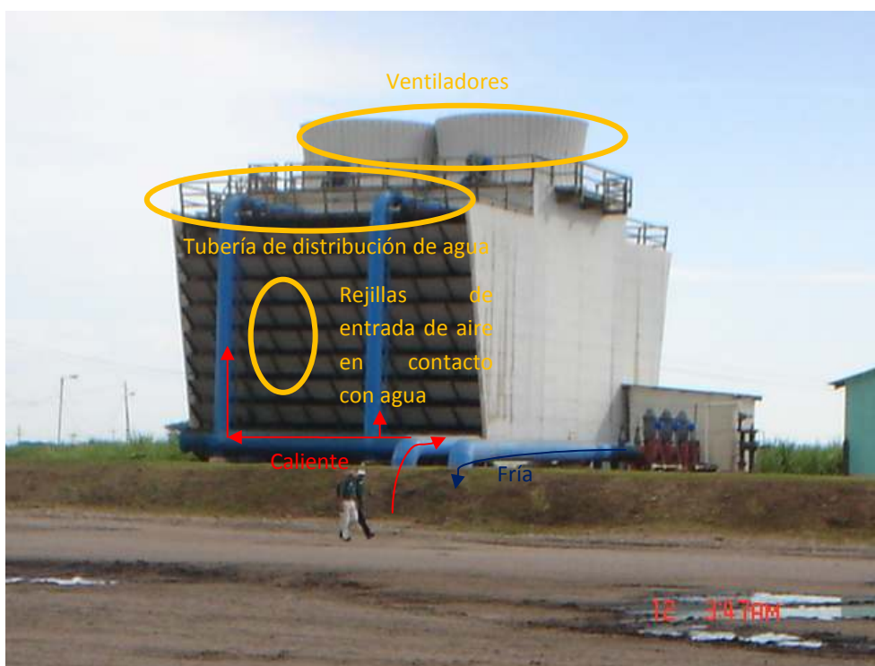
Ilustración 3.23: Torre de enfriamiento
