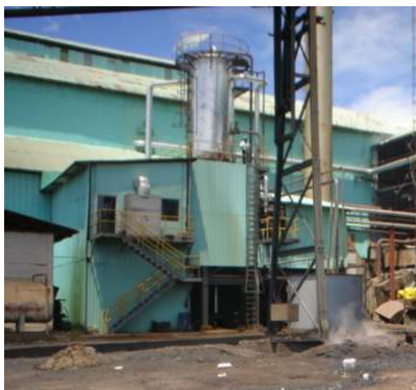
Ilustración 3.25: Deareador de la planta térmica
