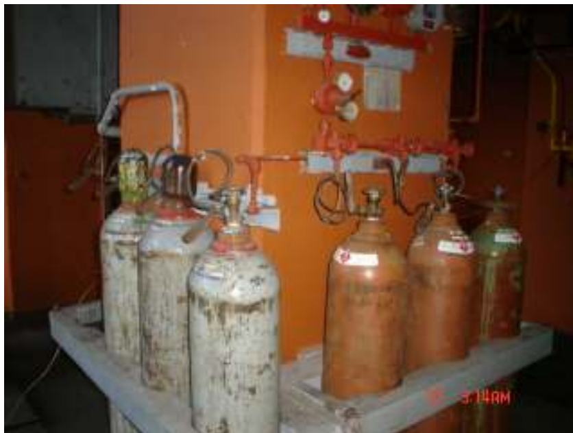
Ilustración 9.5: Cilindros de hidrógeno para el enfriamiento del generador
