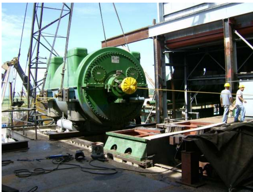
Ilustración 5.9: Instalación de la turbina
