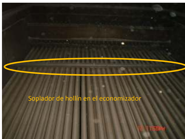
Ilustración 3.16: Soplador de hollín instalado en el economizador para remover cenizas
