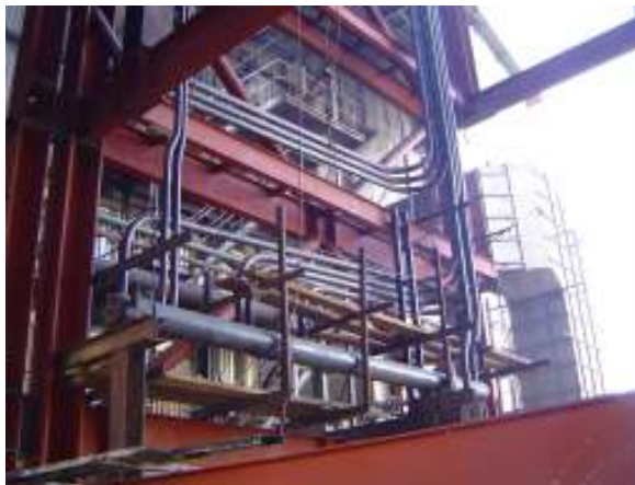
Ilustración 5.6: Tubería en pared lateral de la caldera
