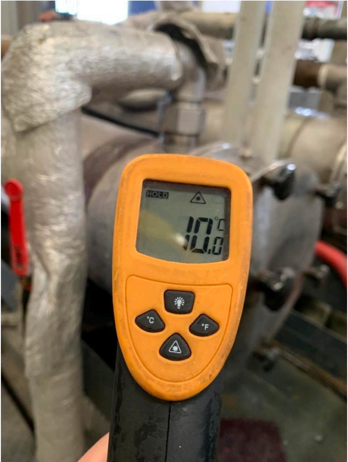
Figura 25. Medición de temperatura con termómetro láser en entrada de agua de chiller a intercambiador.
