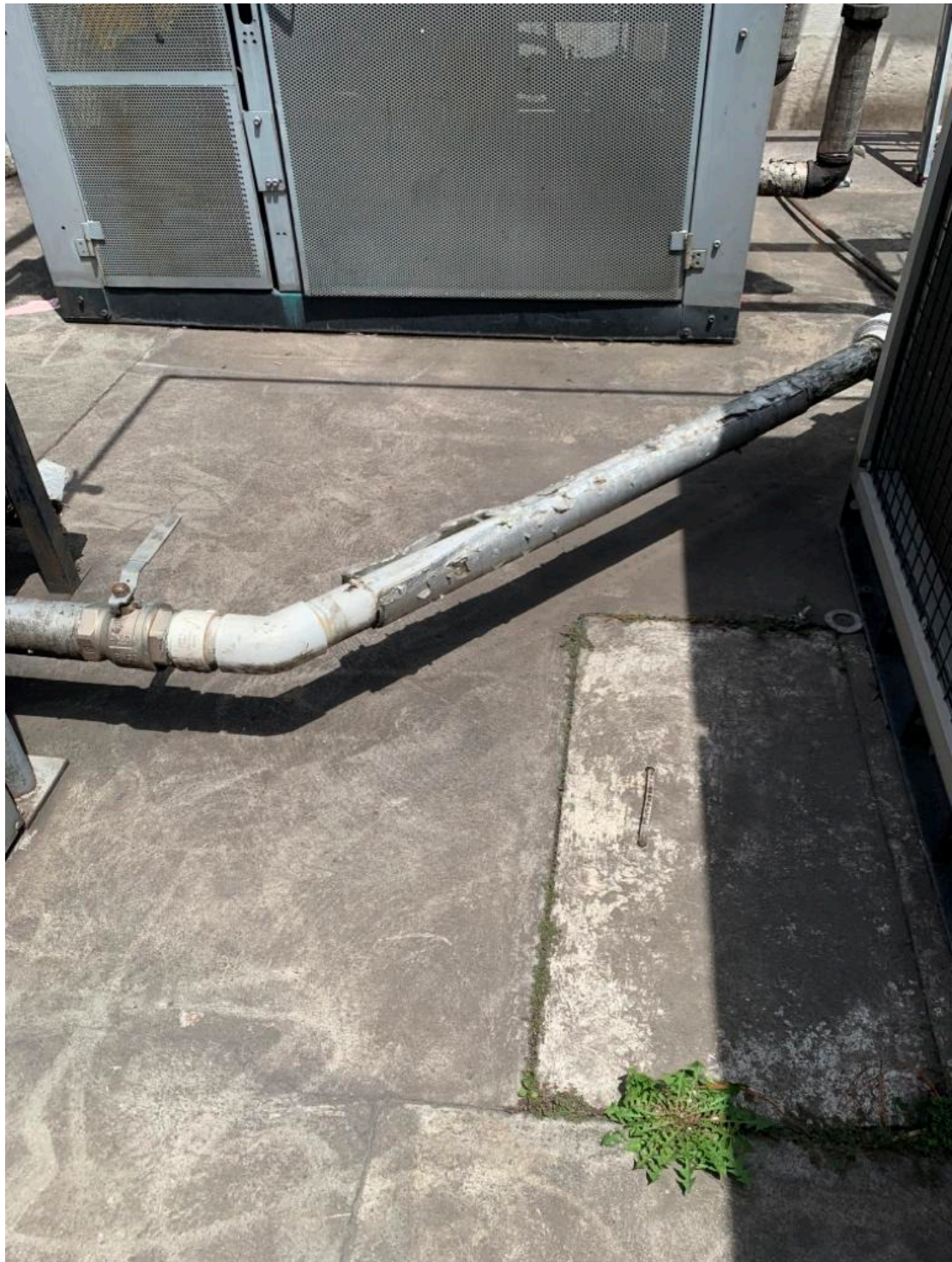
Figura 21. Tubería exterior de enfriador con aislante en mal estado.
