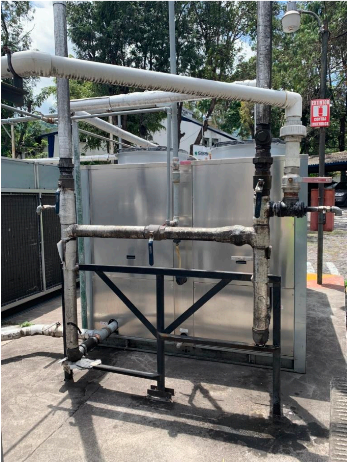
Figura 22. Enfriador de línea de intercambiadores de calor de extrusor.
