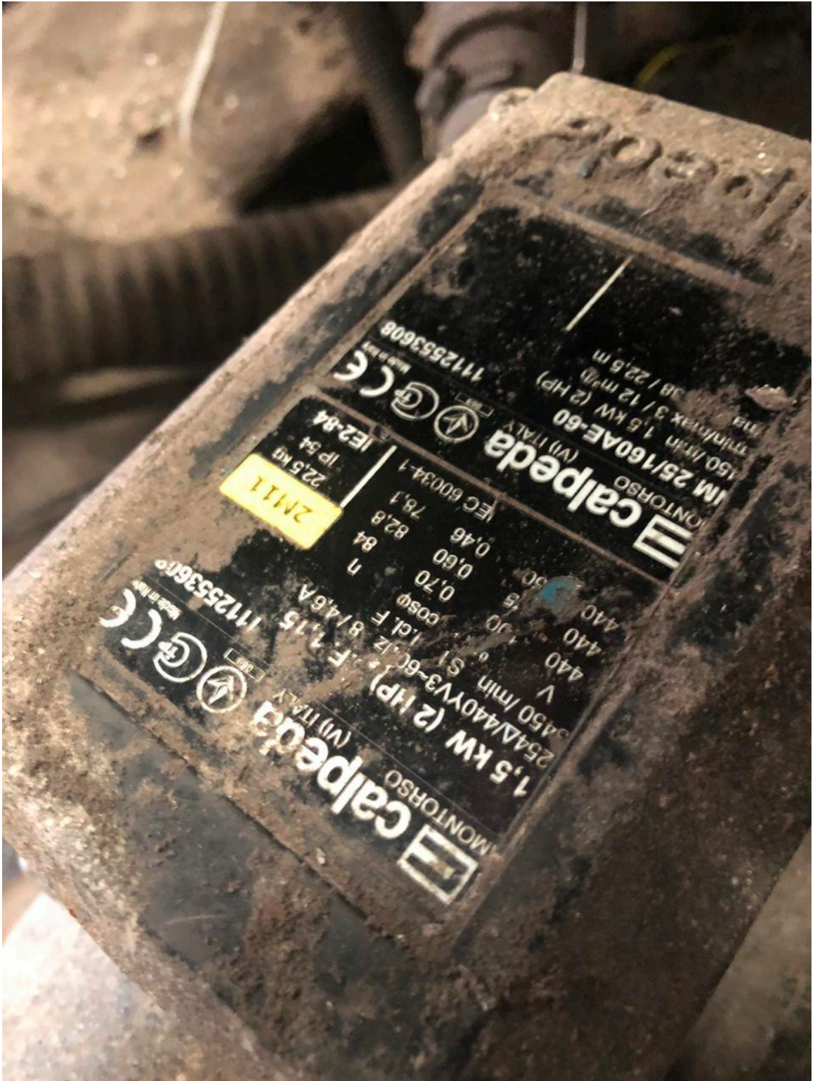
Figura 27. Placa de datos de bomba de intercambiador.
