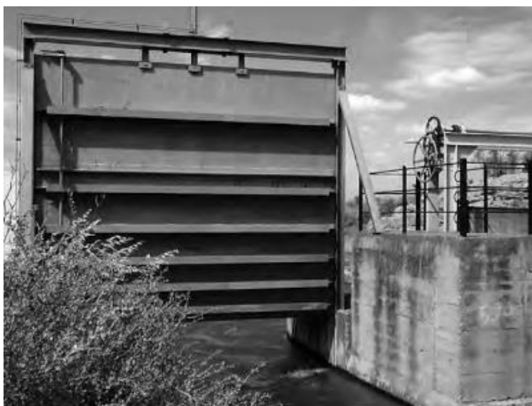
Figura 6. Compuerta de movimiento vertical de tipo deslizante.
