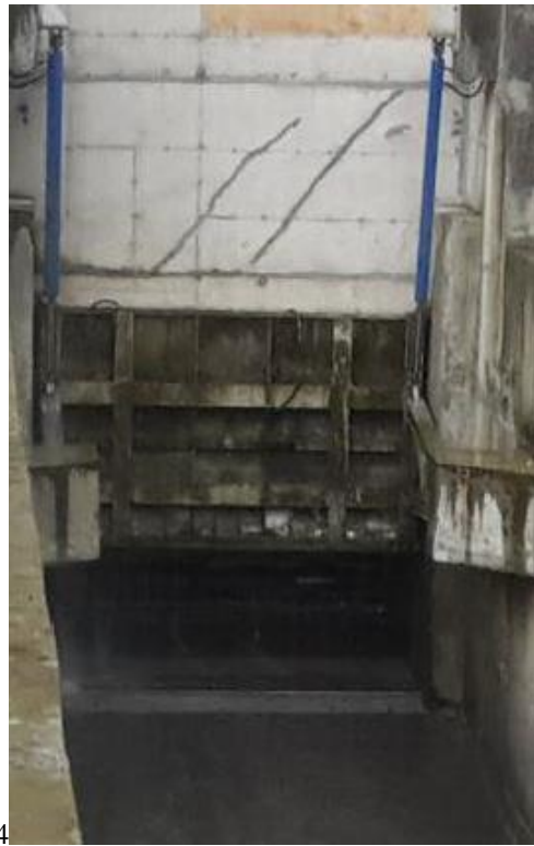
Figura 42. Regulación de nivel, apertura de compuerta radial al 70%.
