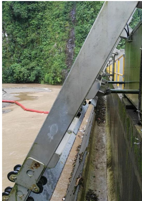
Figura 35. Limpieza de rejillas, peines hidráulicos nuevamente en posición inicial arriba y abiertos.
