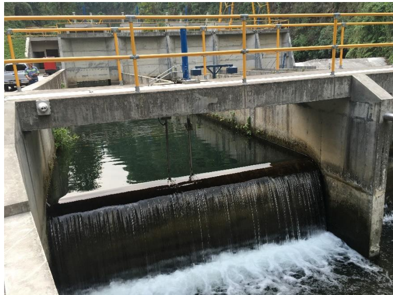
Figura 27. Muestra del vertedero en la salida de un canal del desarenador longitudinal.
