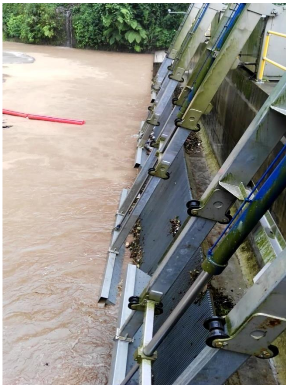
Figura 33. Limpieza de rejillas, peines hidráulicos subiendo y cerrados con desechos retenidos en la rejilla.
