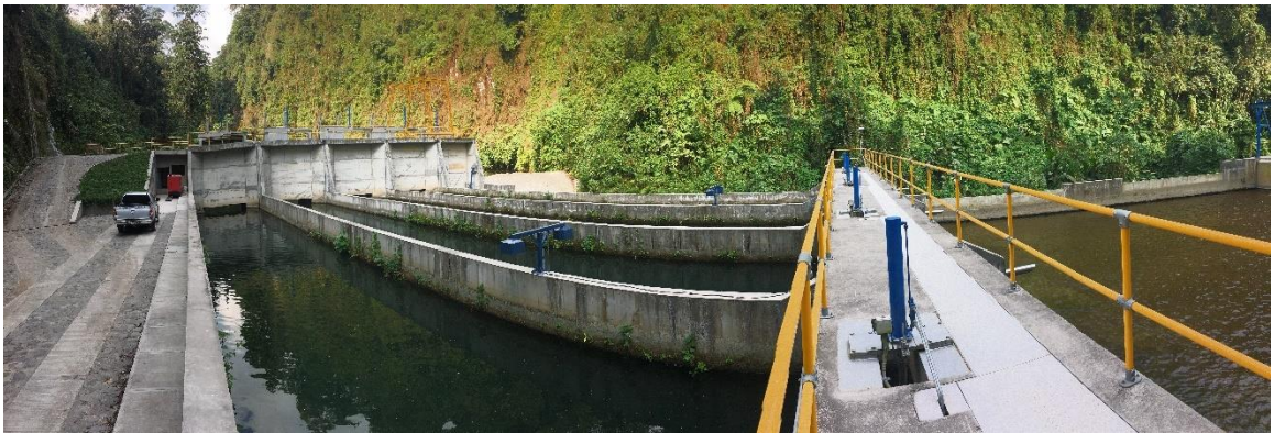
Figura 26. Vista panorámica del desarenador longitudinal de cuatro canales.
