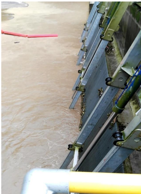
Figura 32. Limpieza de rejillas, peines hidráulicos abajo y cerrados.
