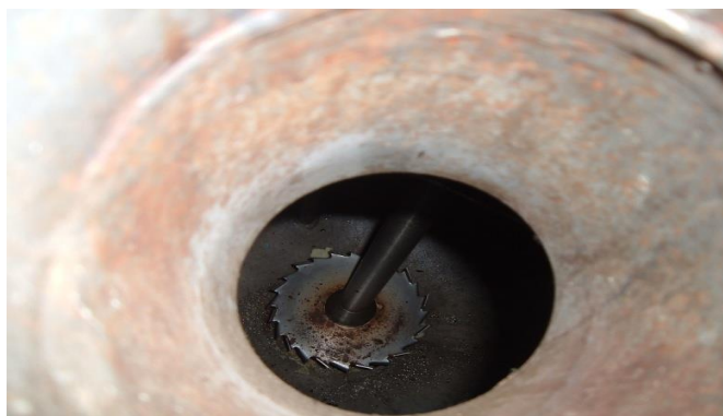
FIGURA 21: Agitador dentro de reactor continuo
