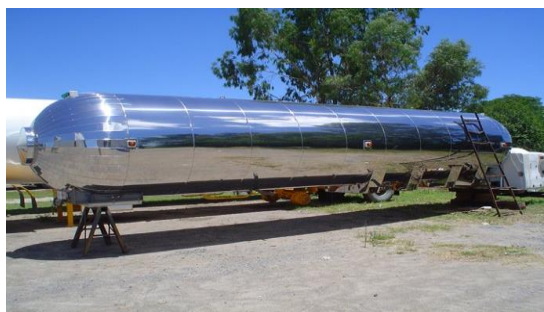
FIGURA 27: Tanque de almacenamiento de hidrógeno.
