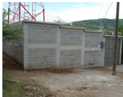
Fotografía 4. Sitio tipo de torre autosportada
