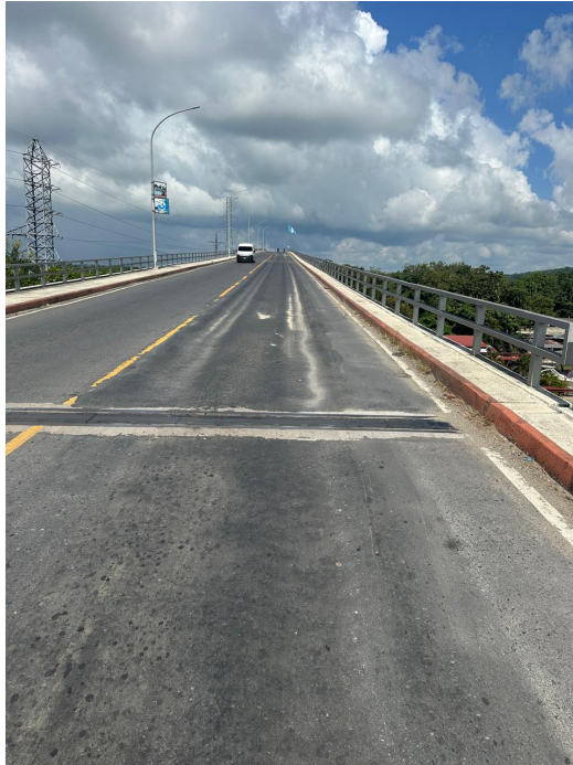
Figura 46. Huella de rodadura en puente río Dulce
