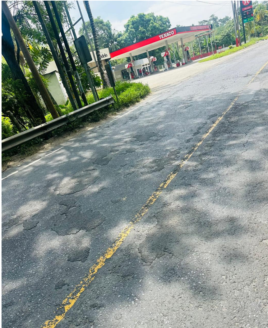
Figura 8. Pérdida de agregados (Km. 205 CA-9 Norte).
