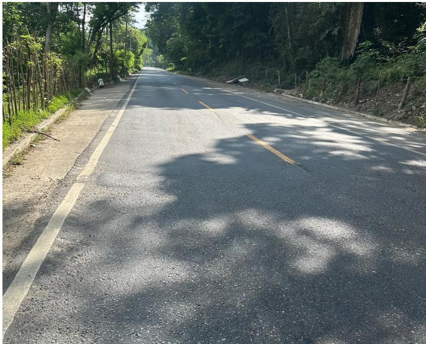
Figura 7. Ahullamiento transversal (Km. 254 CA-13)
