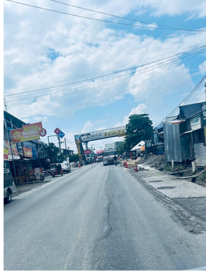
Figura 6. Ahullamiento longitudinal (Km. 200 CA-9 Norte)
