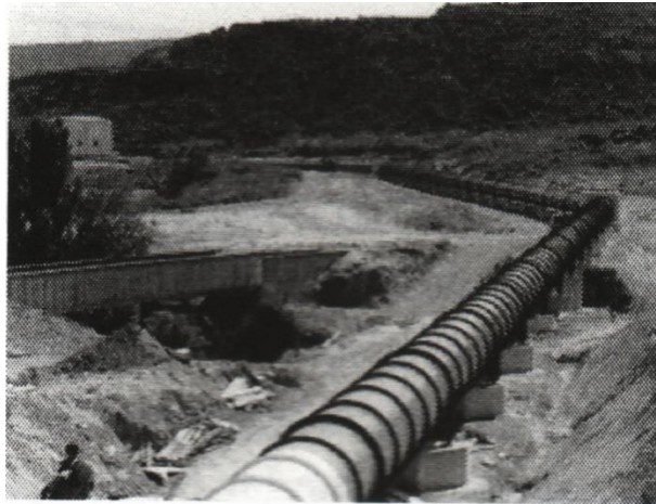
Figura No.10 Tubería aérea
