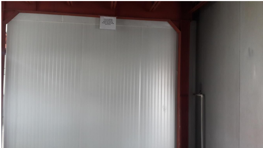
Fotografía 1 Exterior de nuevo cuarto frío
