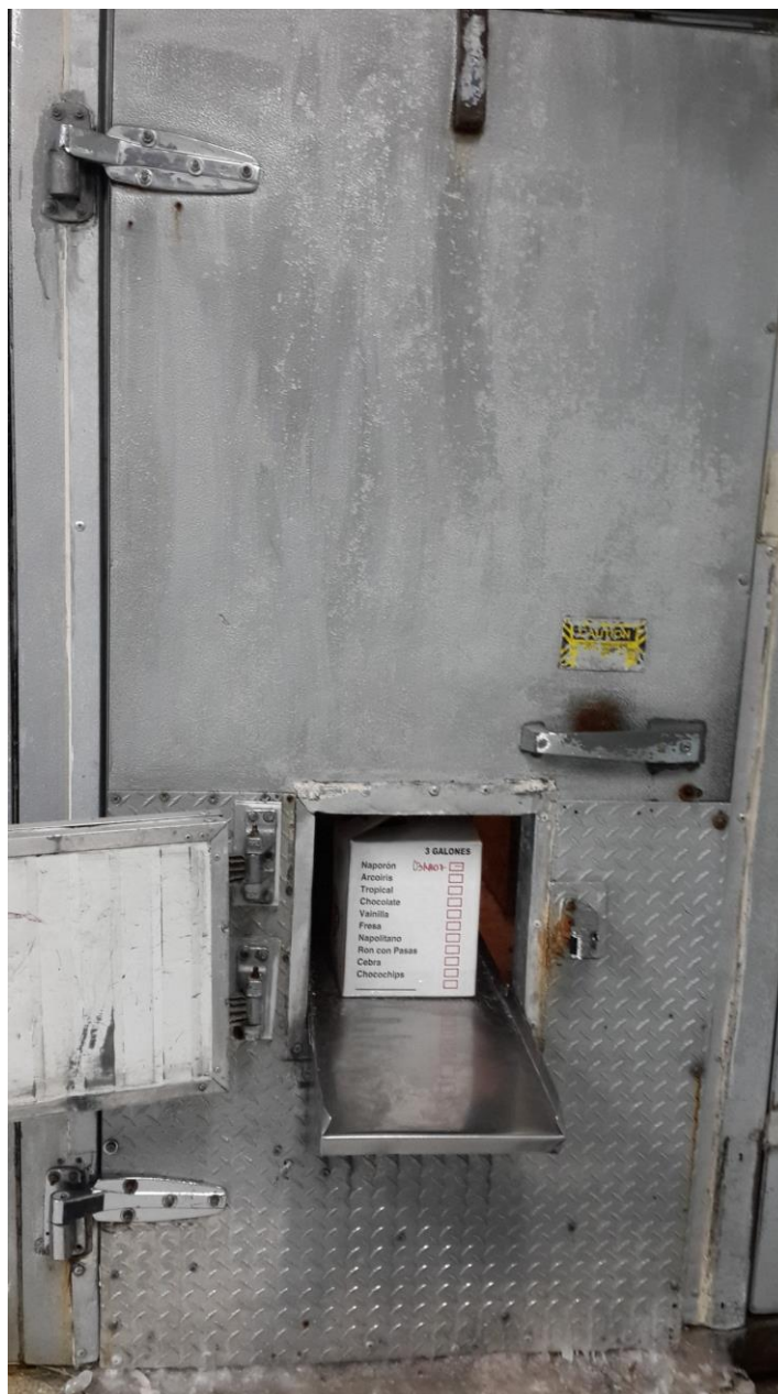
El producto terminado entra al cuarto frío por esta escotilla
