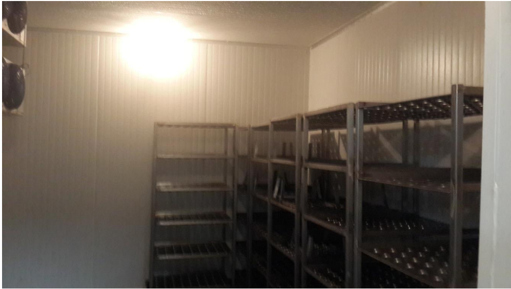
Fotografía 19 Interior de nuevo cuarto frío
