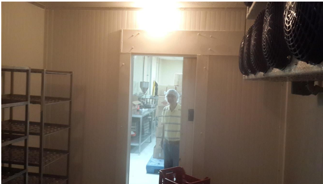
Fotografía 20 Interior de nuevo cuarto frío
