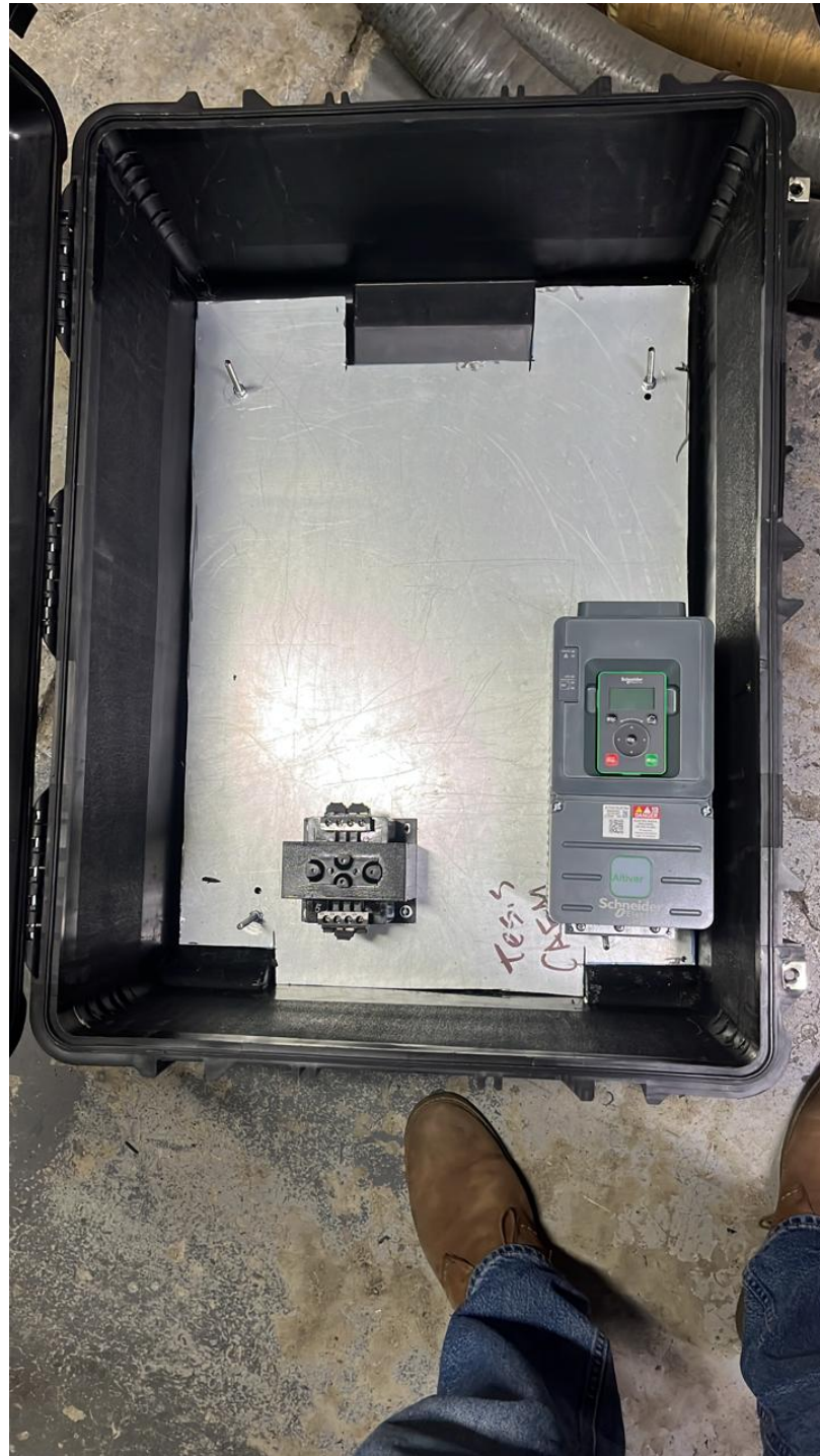
Figura 54. Transformador y Variador de Frecuencia instalado
