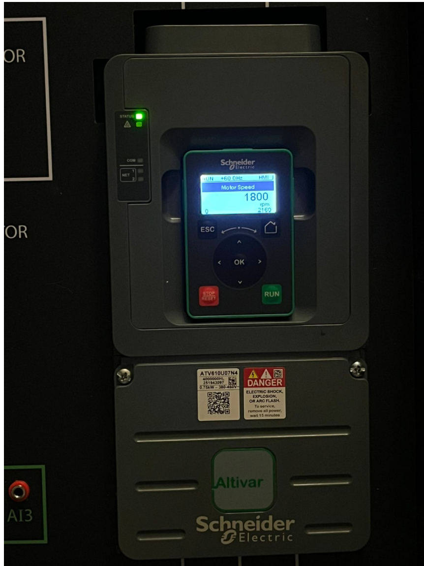
Figura 63. Funcionamiento correcto del variador de frecuencia
