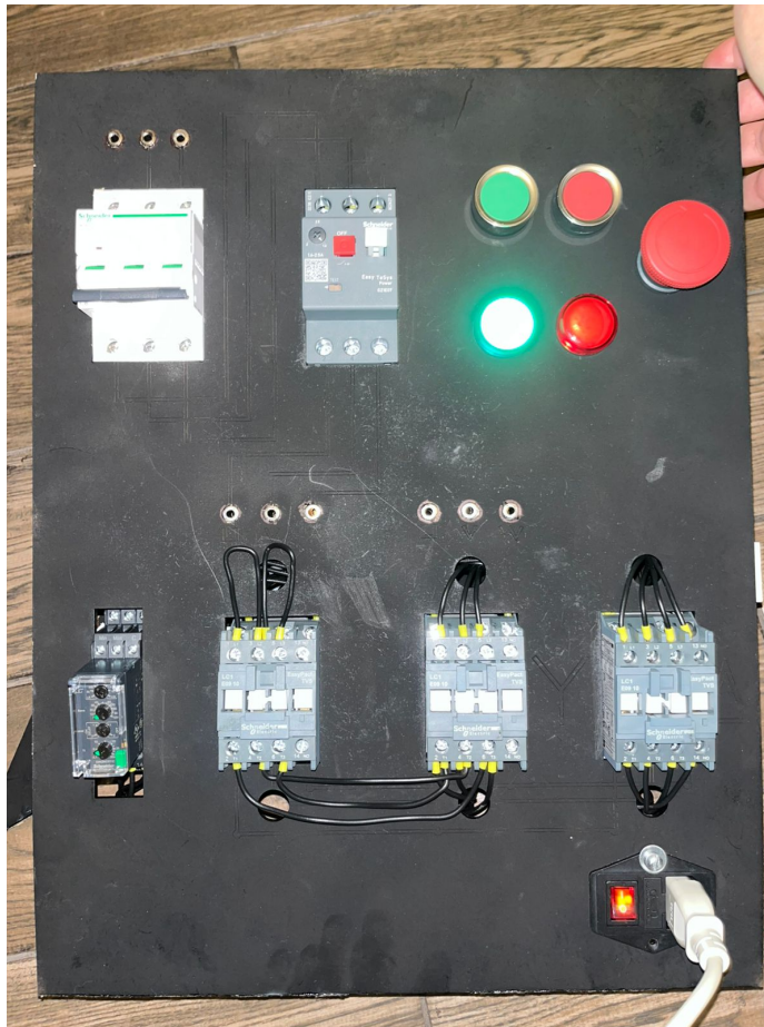
Figura 64. Funcionamiento correcto del arranque estrella-delta señal run
