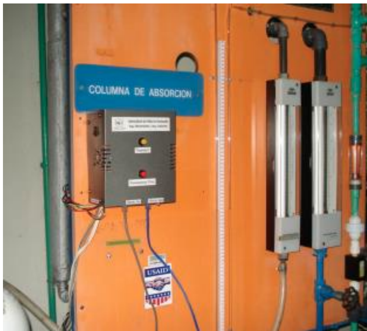
Figura 20. Botonera y medidores de flujo de la segunda fase de automatización.
