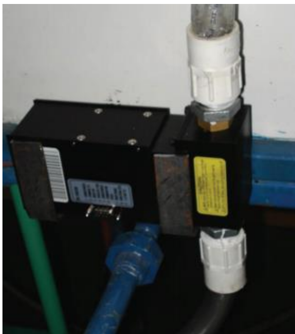
Figura 21. Válvulas proporcionales segunda fase de automatización.
