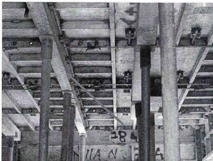
Ilustración No. 40 Vigas I "Encinos 6 de Cayalá"
