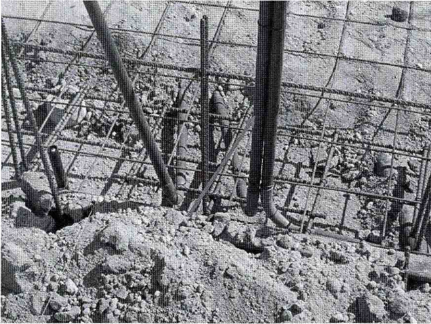
Ilustración No. 23 Instalación eléctrica "Encinos 6 de Cayalá"
