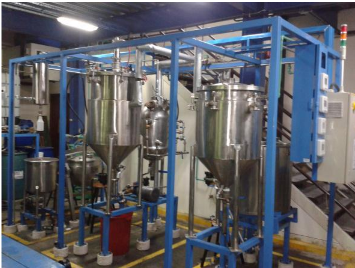
Figura No. 28. Imagen de la planta terminada.
