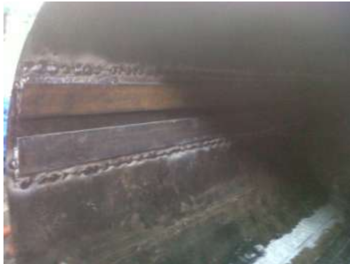
Figura No. 20 Rieles de placas deflectoras soldadas en el interior del tanque
