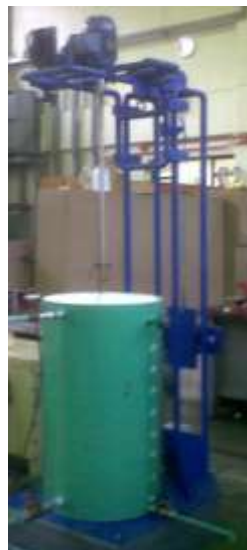
Figura No. 26 Base del motor y agitador
