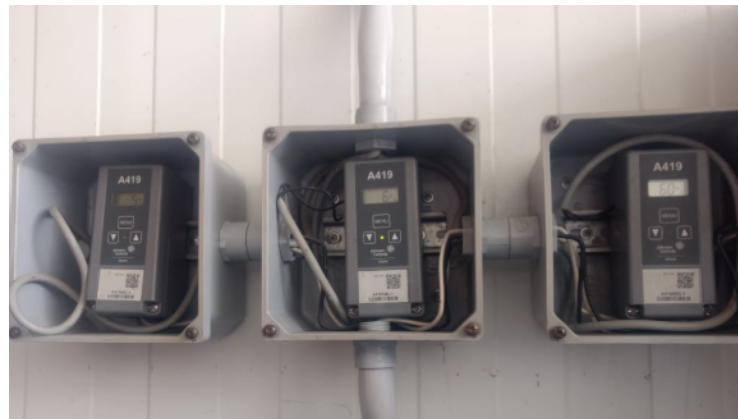
Figura 57: Control de temperatura
