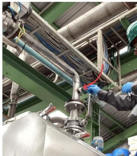
Figura 44. Tubería 1 hacia envasadora, punto de muestreo
