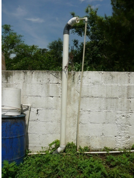
Figura 27: Filtro de sulfuro de hidrógeno para el biogás del digestor anaerobio de la Granja La Flor.
