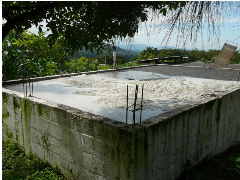
Figura 18: Tanque de captación del digestor anaerobio de la Granja La Flor
