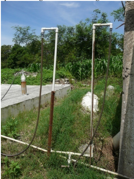
Figura 25: Trampa de agua para el biogás saliente del digestor anaerobio de la Granja La Flor.
