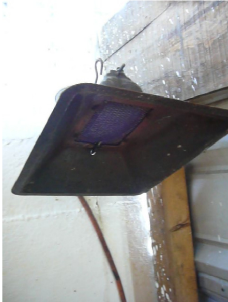
Figura 39: Quemador de biogás en operación.
