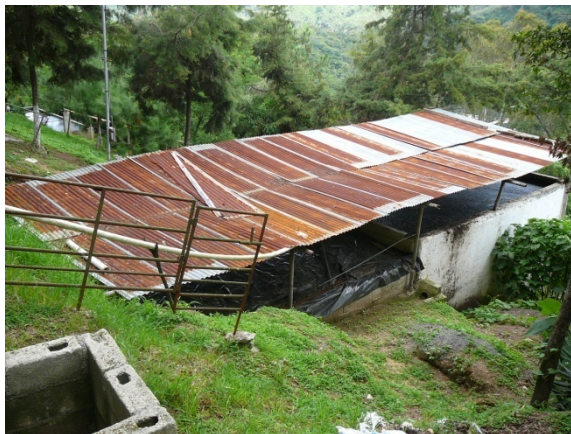
Figura 30: Salida del biogás del digester anaerobio de la Granja Agua Blanca.
