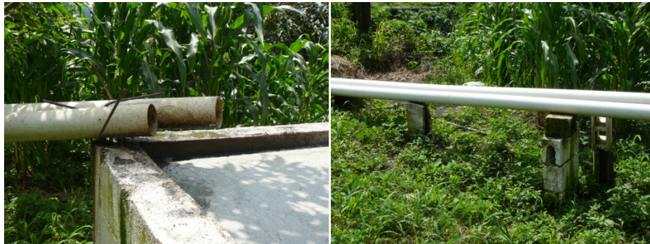
Figura 19: Sistema de conducción de las aguas residuales hacia el tanque de captación de la Granja La Flor.
