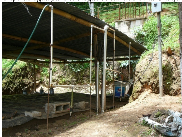
Figura 36: Trampa de agua para el biogás consumido en la Granja Agua Blanca.
