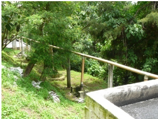
Figura 33: Conducción desde el tanque de estabilización hacia la segunda pileta de estabilización, en la Granja Agua Blanca.
