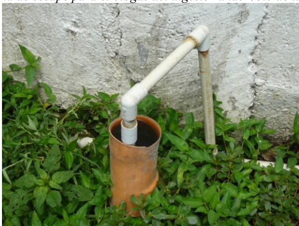
Figura 26: Sistema de escape para el biogás del digestor anaerobio de la Granja La Flor.
