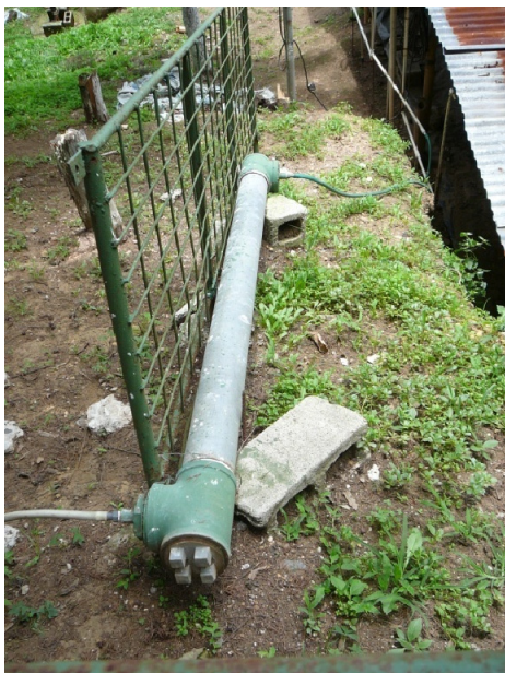
Figura 37: Filtro de sulfuro de hidrógeno para el biogás consumido en la Granja Agua Blanca.
