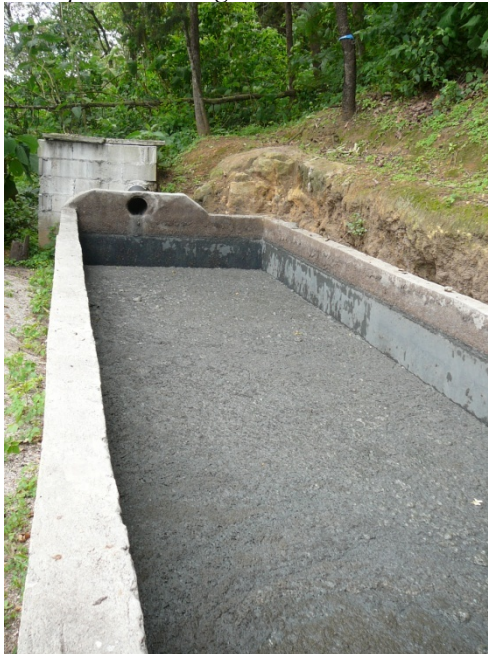
Figura 28: Tanque de captación del digestor anaerobio de la Granja Agua Blanca.
