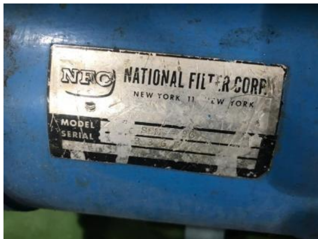
Figura 267. Bomba centrífuga conectada al sistema de enfriamiento
