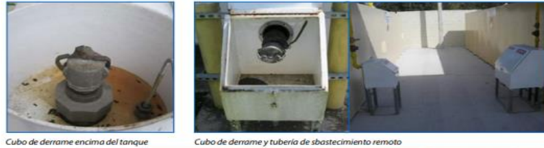
Cubo de derrame encima del tanque
