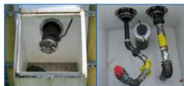
Tapas de la tubería de abastecimiento
