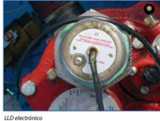
Figura 18. Detector de fuga en la tubería
