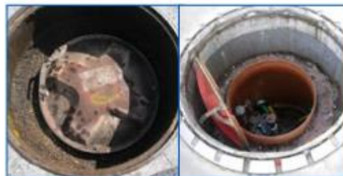
Cobertura del sumidero cerrada Cobertura del sumidero abierta
