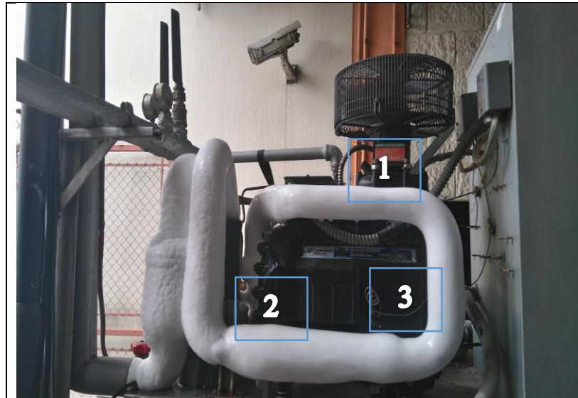
Anexo 5. Evaluación de temperaturas del compresor Copeland No. 5
