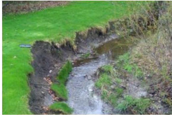
Figura 2: Erosión por agua
