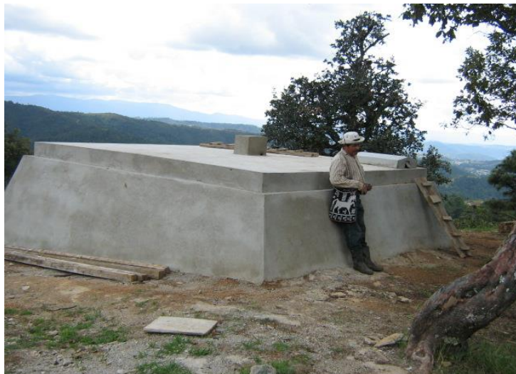
Figura No. 04: Tanque de distribución: Canshac, Huehuetenango, Huehuetenango
