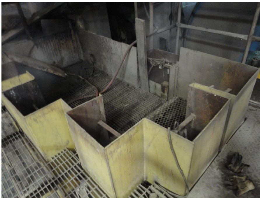
Ilustración No. 95 – Vista aérea del tanque de distribución que alimenta a los filtros.
