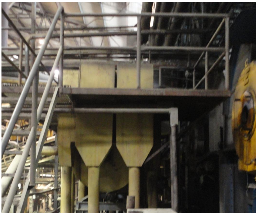
Ilustración No. 96 – Vista lateral del tanque distribuidor que alimenta a los filtros.
