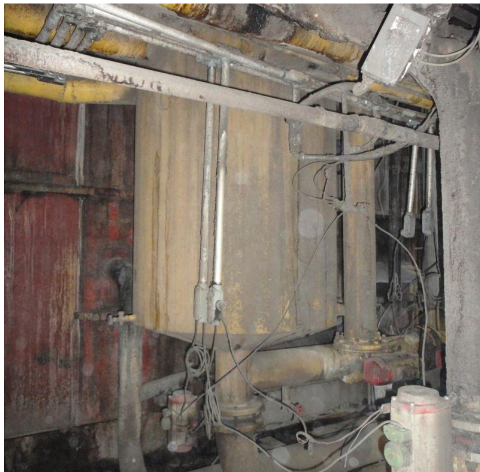
Ilustración No. 99 – Tanque de jugo filtrado.
