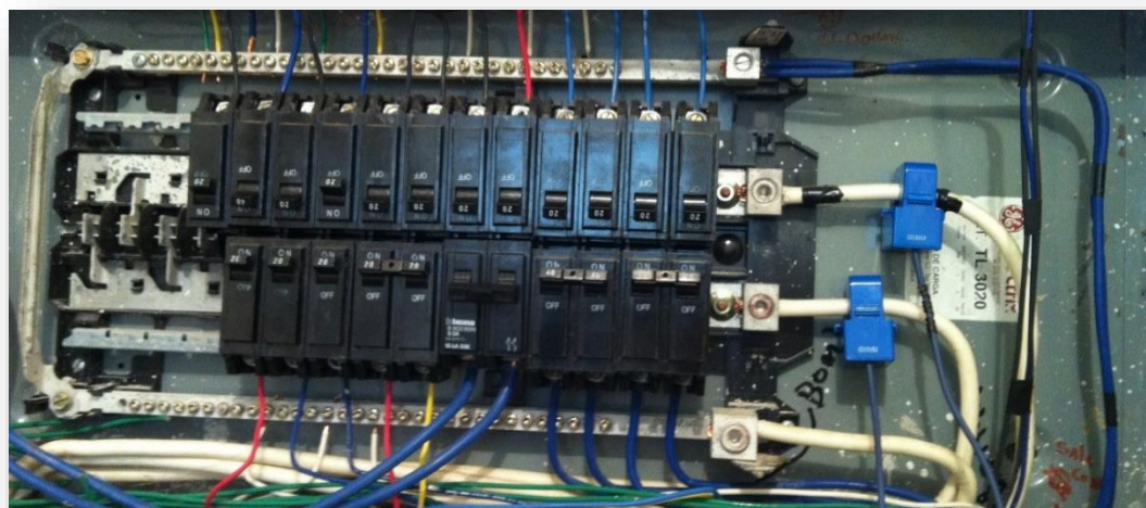
Figura No. 29: Sensores instalados - frontal.
