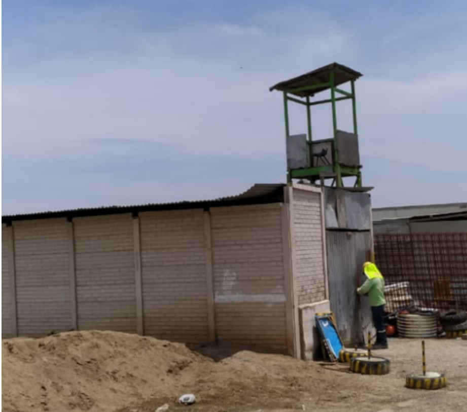
Figura 33: Torre de control en bodega
