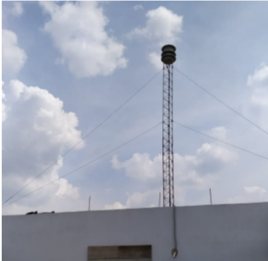
Figura 34: Alarma de sirena en SDF
