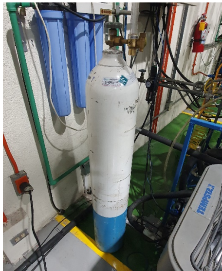
Figura 39. Tanque de dióxido de carbono
