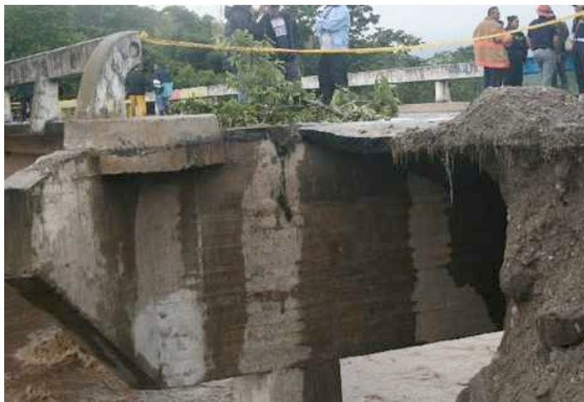
Figura 29: Puente las Cañas en Santa Rosa con aproximaciones dañadas.
