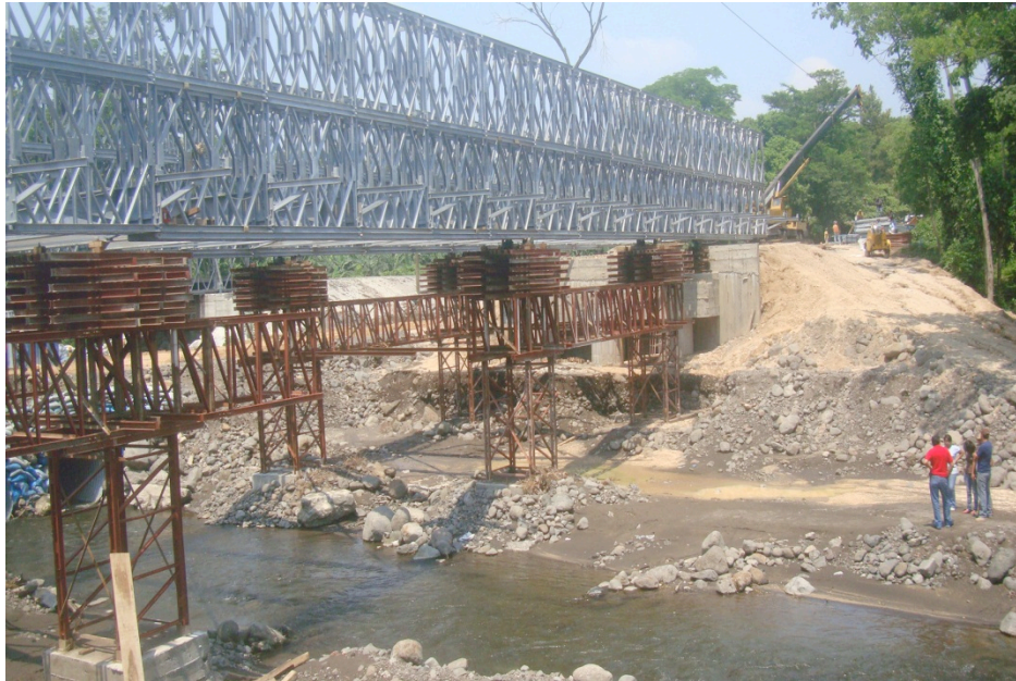
Figura 39: Puente Bailey doble vía,
