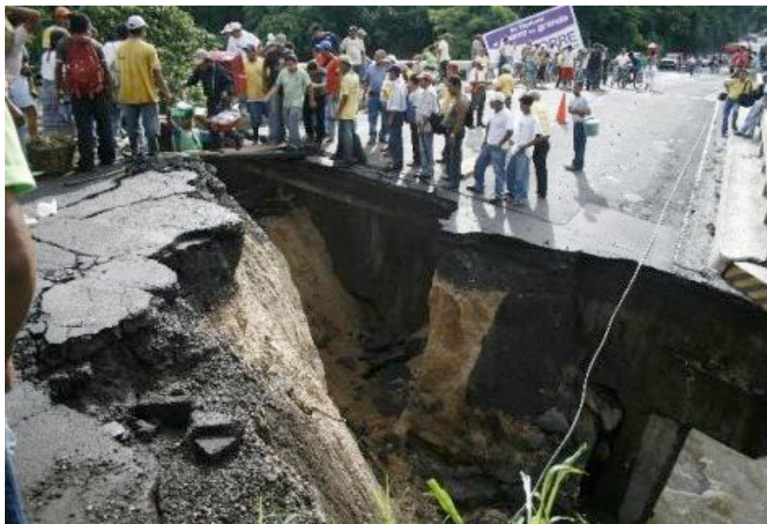
Figura 32: Socavamiento en Puente San Francisco Km 126 carretera al Pacifico
