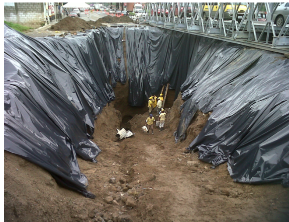
Figura 99: Hundimiento en Km14 Carretera al Pacifico
