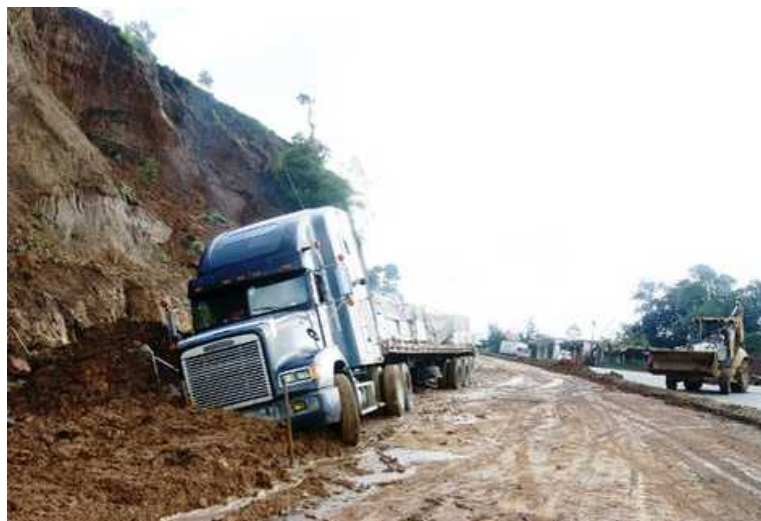
Figura 45: Derrumbe bloquea Ruta Interamericana
