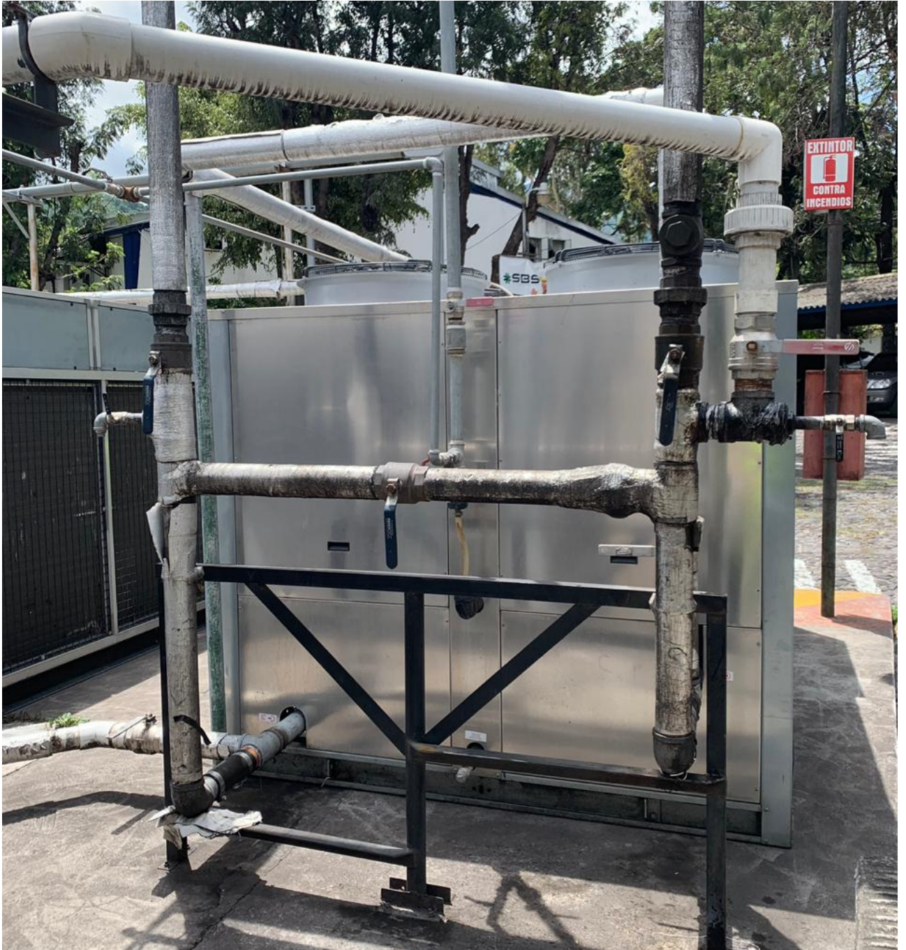
Figura 21. Tubería con aislante PE
