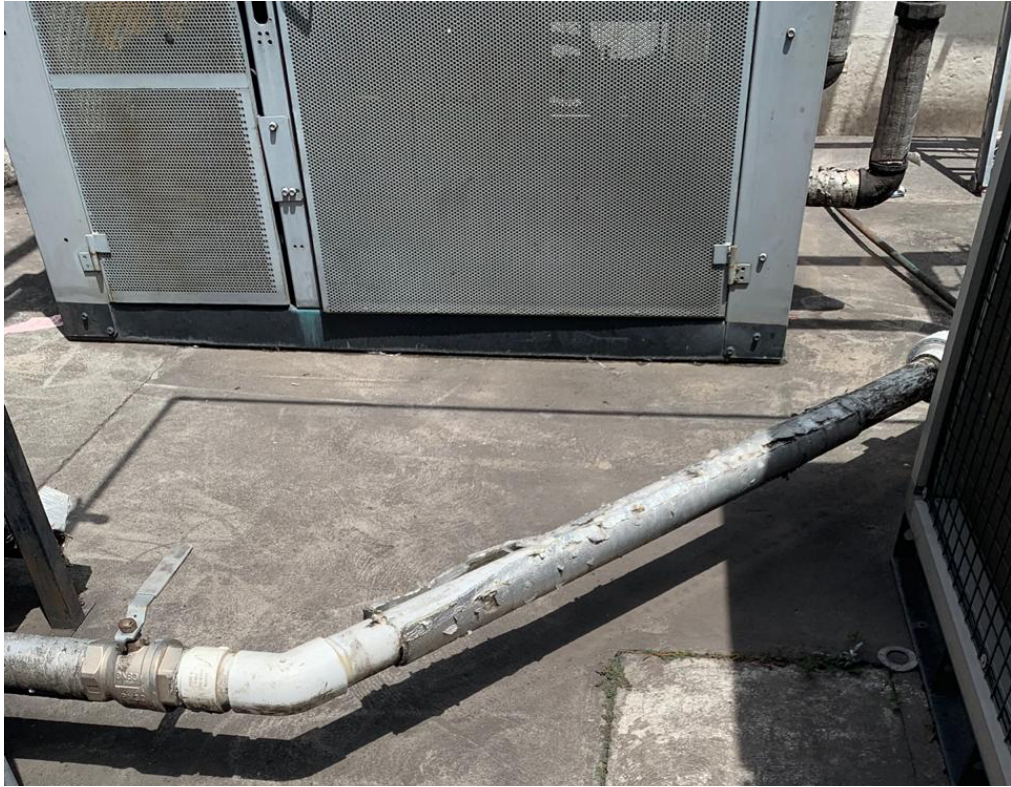
Figura 20. Desgaste de aislante en enfriador (PE)
