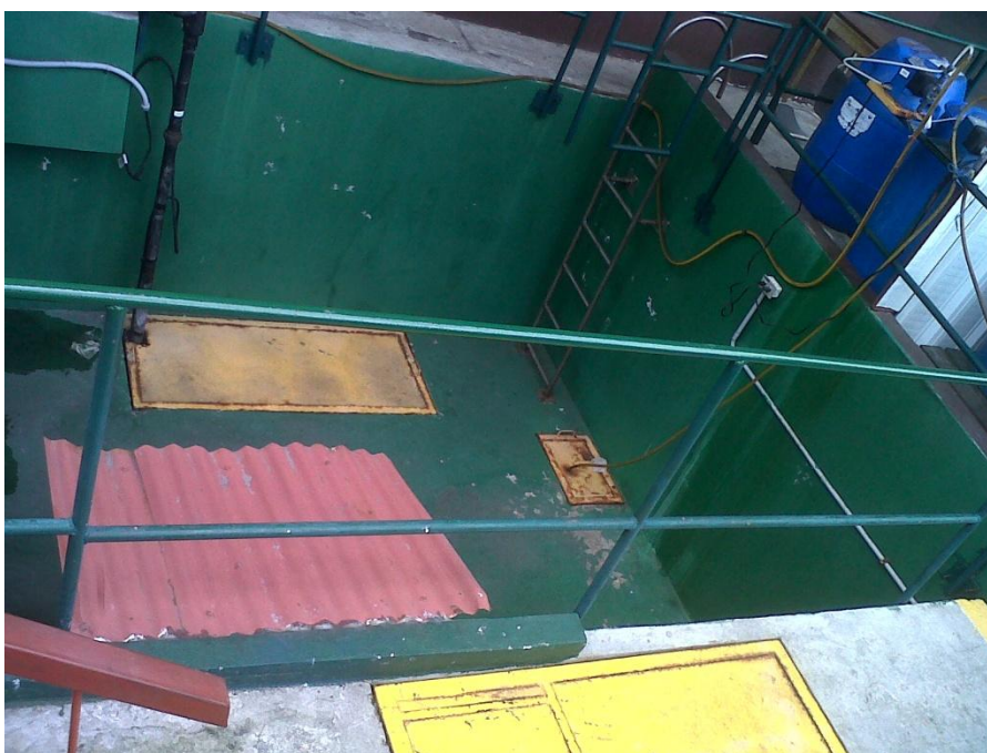
Imagen 3 Tanque de bombeo y acumulación de ILG, S.A.
