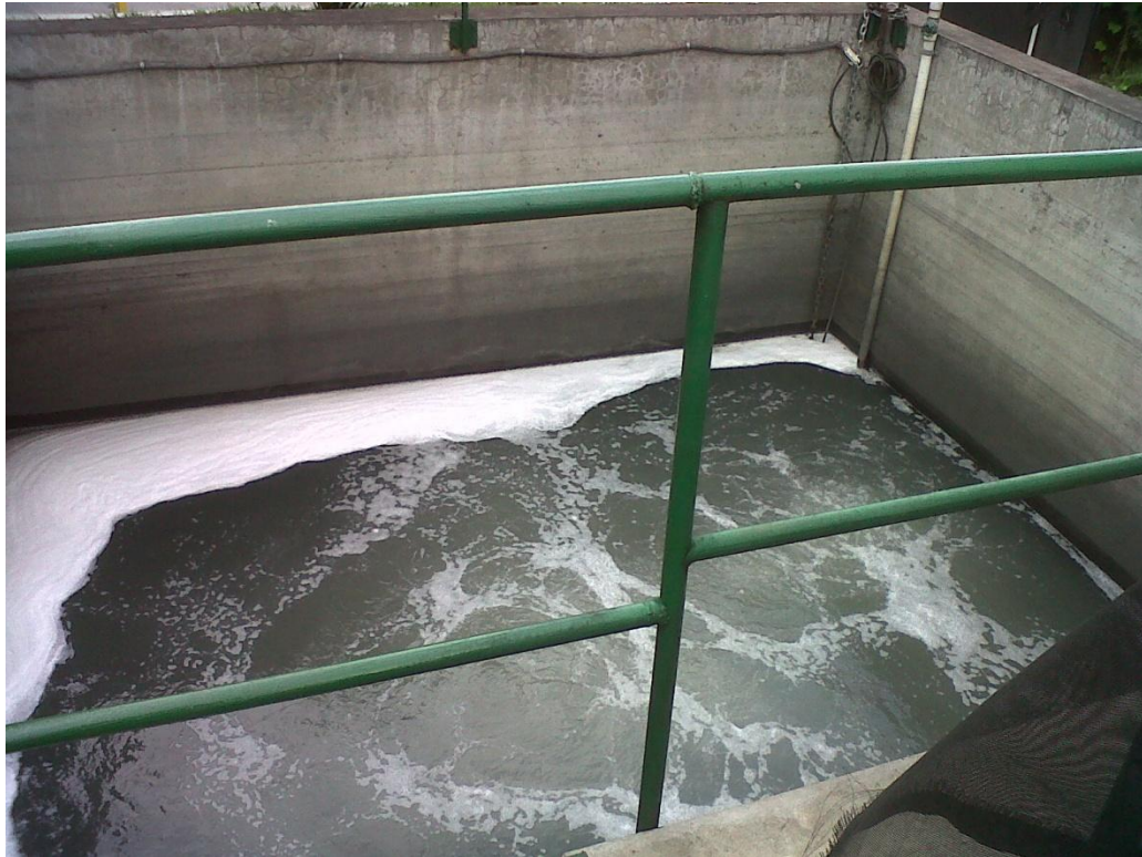
Imagen 5 Tanque de ecualización
