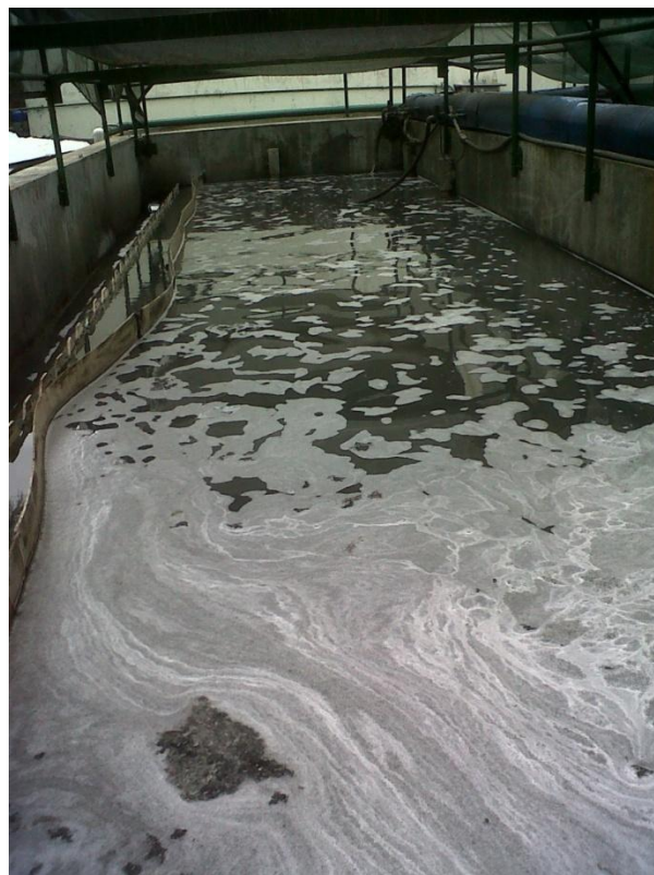
Imagen 8 Tanque de clarificación
