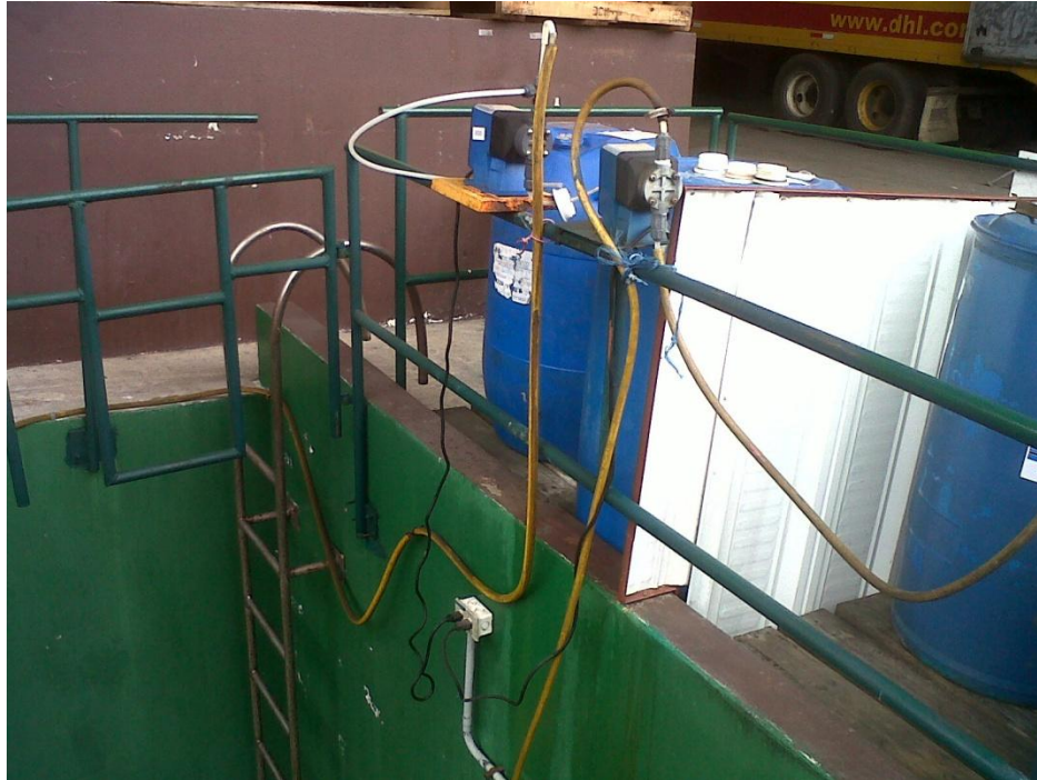
Imagen 4 Parte del Sistema de Control de Ácido Clorhídrico (BOMBAS)
