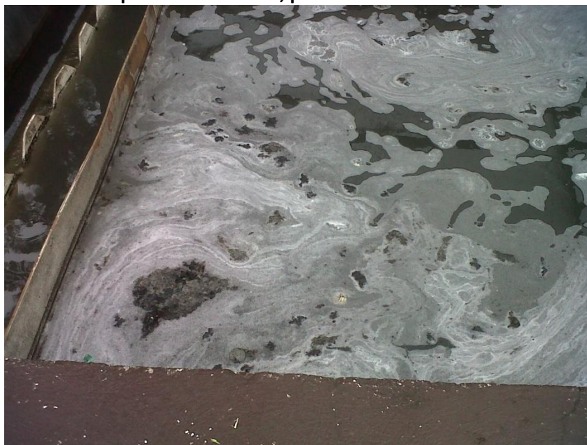
Imagen 9 Tanque de clarificación, problemas fundamentales
