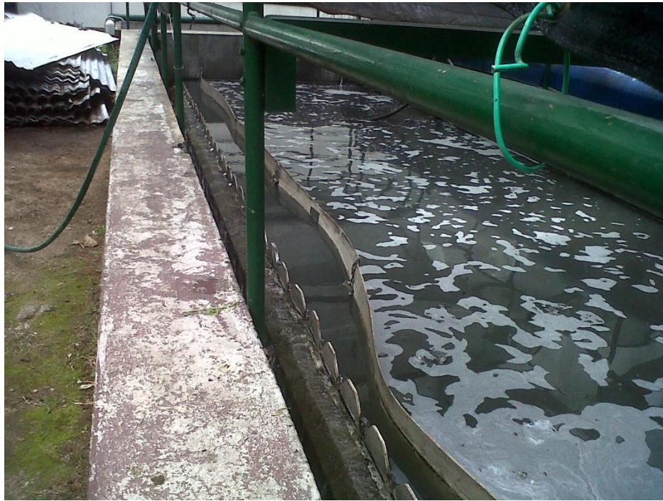
Imagen 7 Tanque de clarificación
