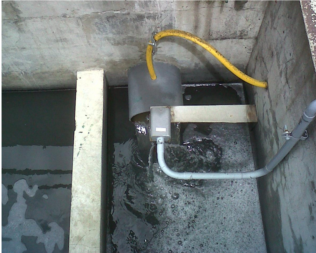
Imagen 11 Inyección de hipoclorito de sodio al agua
