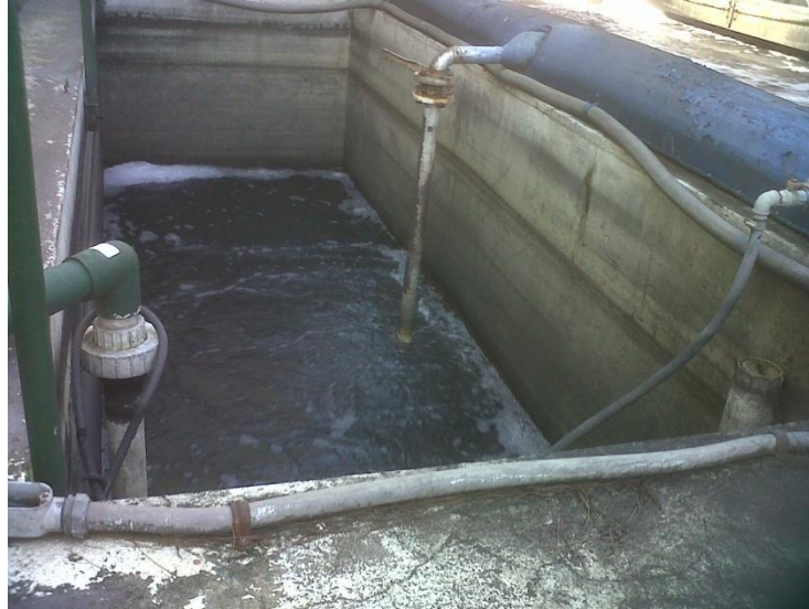
Imagen 12 Tanque de lodos
