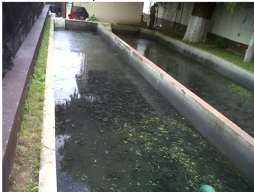
Imagen 13 Tanques de secado de lodos
