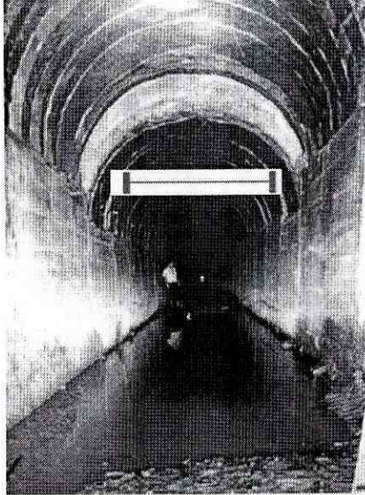
Ilustración 83: Túnel y ubicación de extensómetros.
