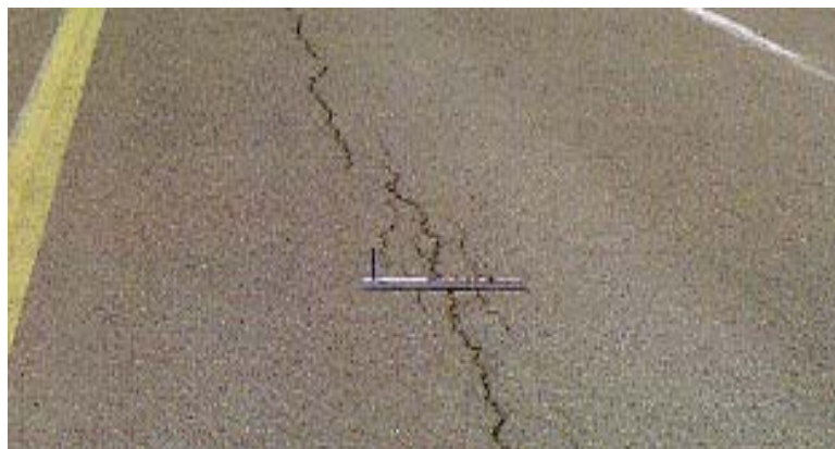
Ilustración No. 4 Agrietamientos longitudinales 9
