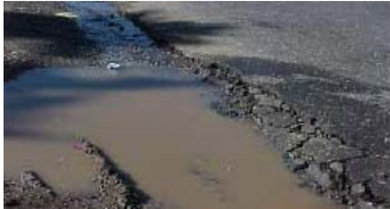
Ilustración No. 3 Agrietamientos en los bordes 8
