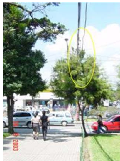
Figura 56 Ciprés entre cables
