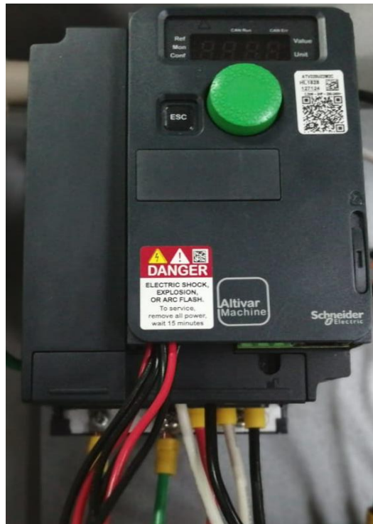
Figura 82. Variador de frecuencia
