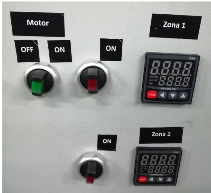
Figura 84. Señalización panel eléctrico
