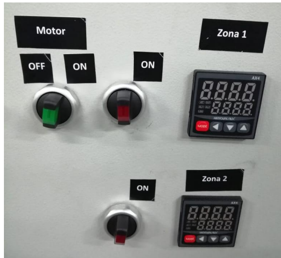
Ilustración 10. Parte frontal del panel eléctrico
