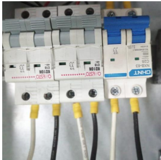
Ilustración 9. Breakers en la posición de encendido.
