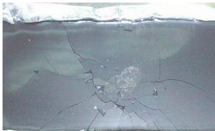
Ilustración 58: Fractura en el asfalto a temperaturas menores de 0°C
