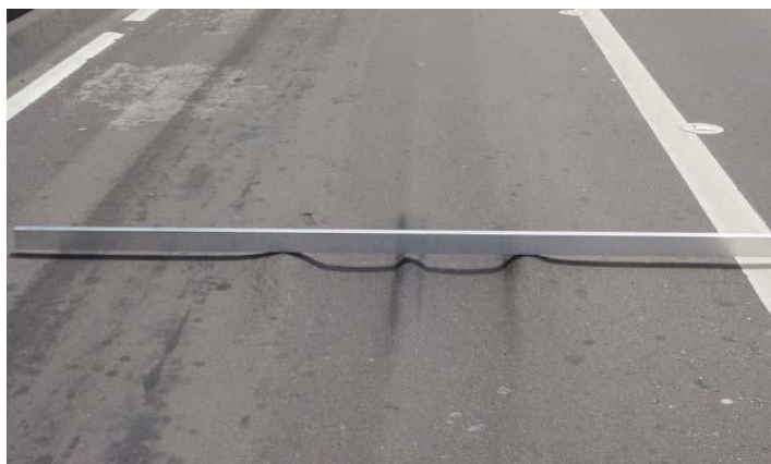
Ilustración 62: Ahuellamiento en una carretera
