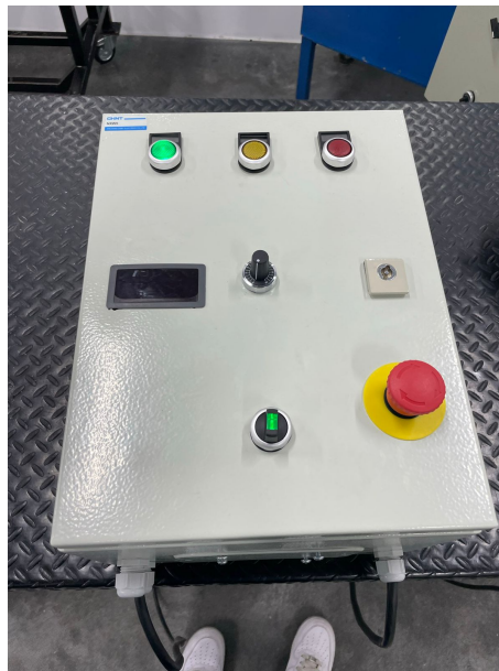
Figura 55: Panel eléctrico concluido
