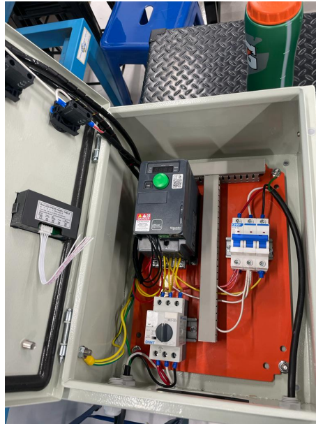
Figura 54: Conexión eléctrica dentro de caja
