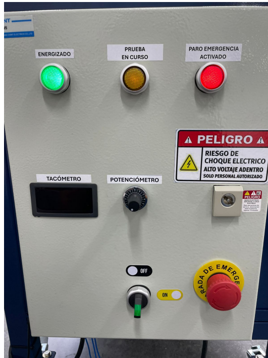
Figura 84: Resultado de paro de emergencia activado, luz piloto roja y verde
